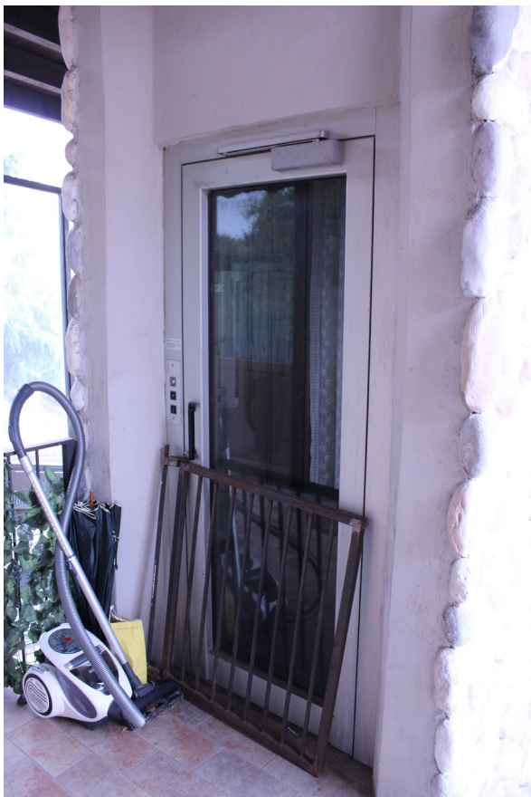
Ascensore fuori servizio
