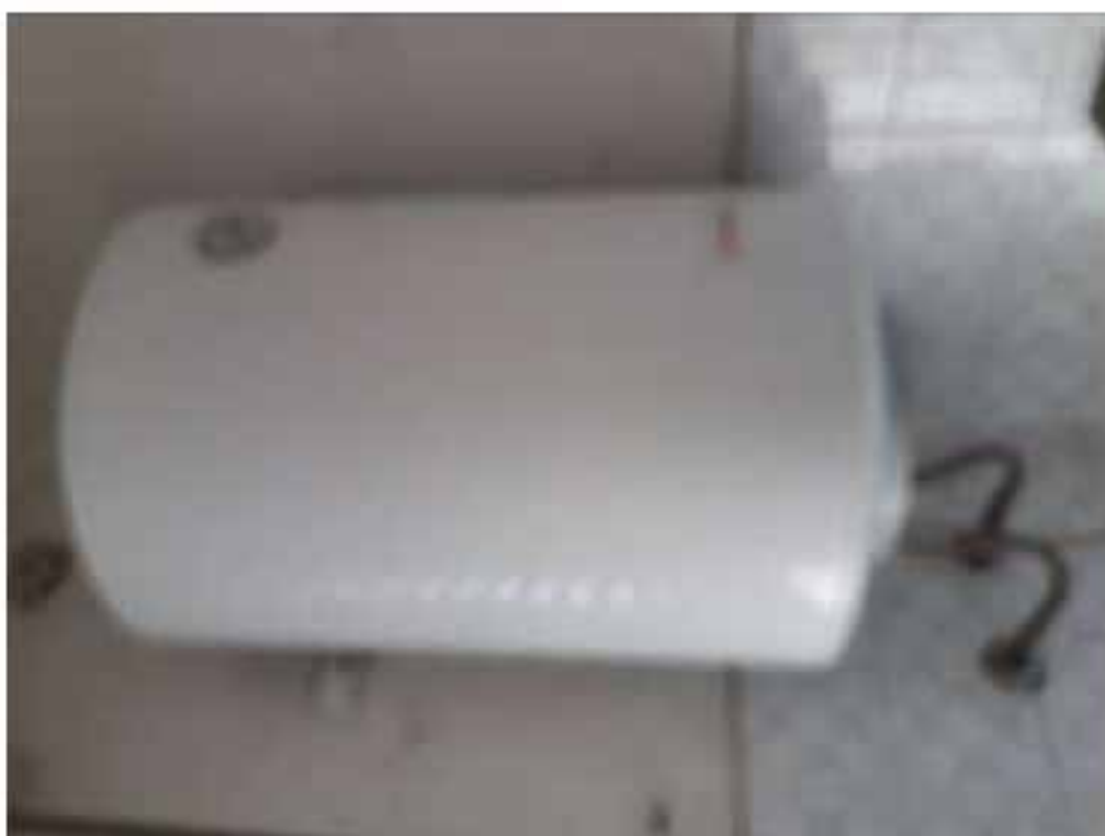
Boiler elettrico bagno
