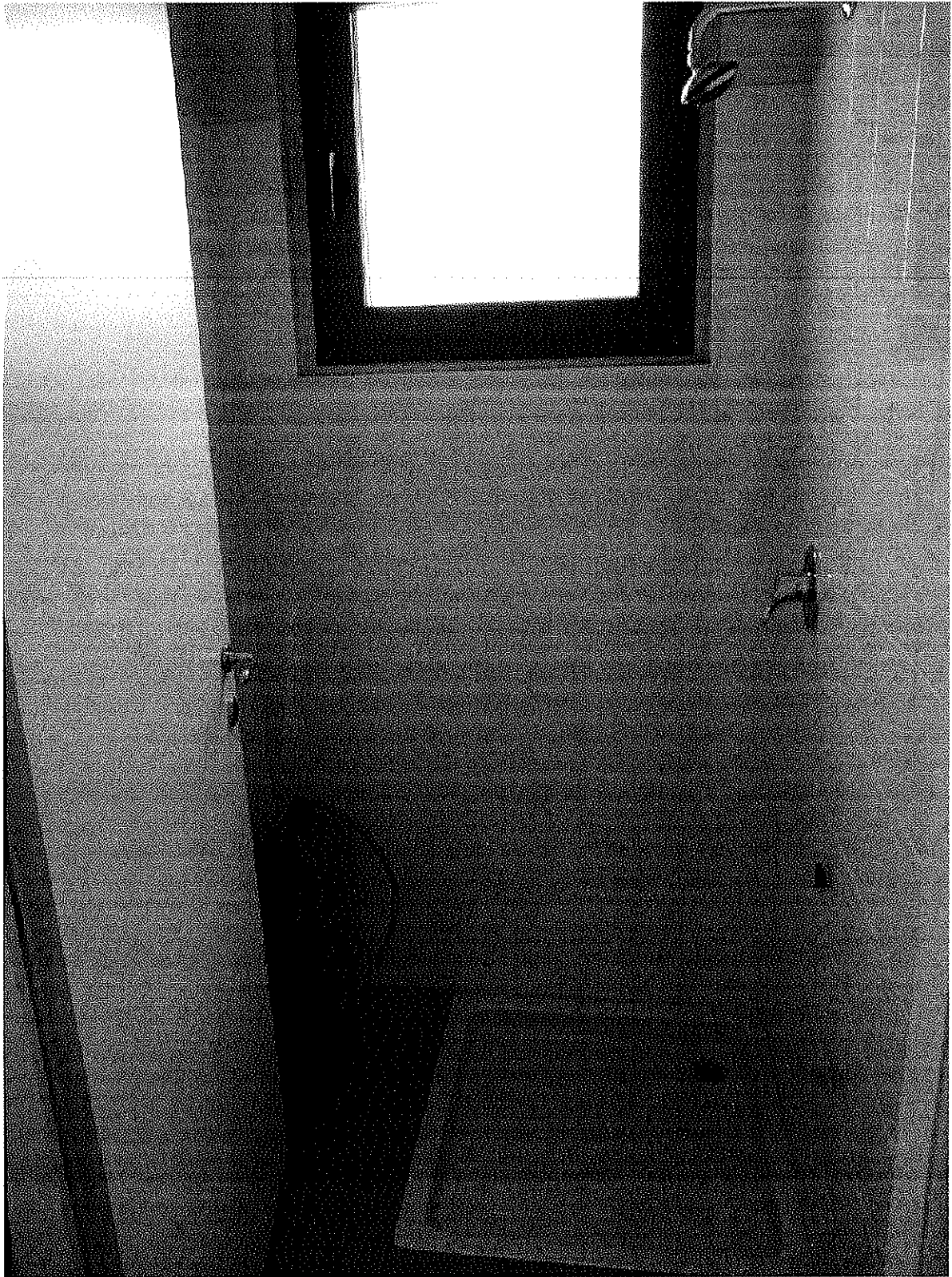
Fig. 27 – Vista della doccia installata nel bagno
