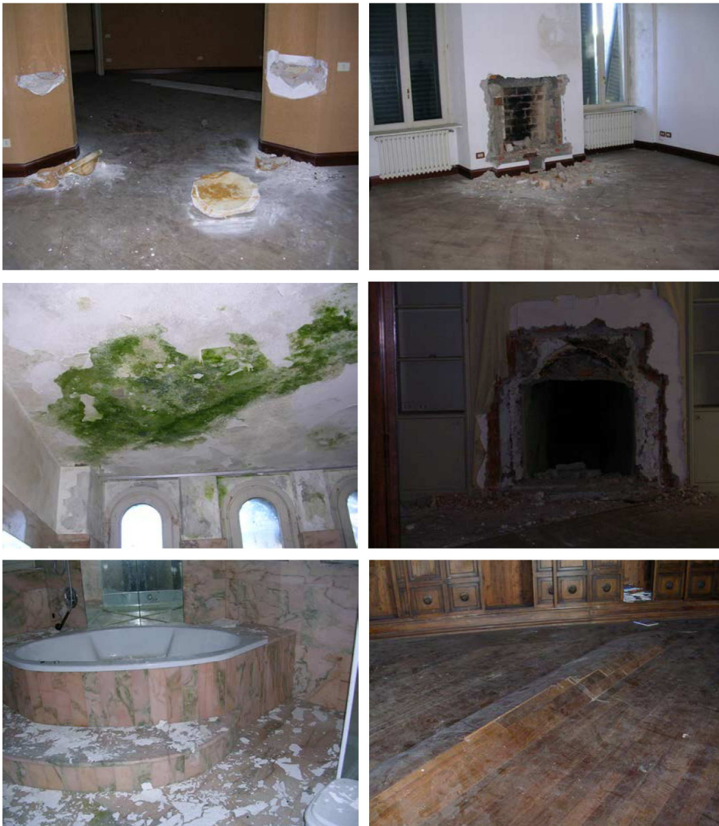
VISTA DELLE PARTI PIU' DANNEGGIATE DELL'INTERNO
