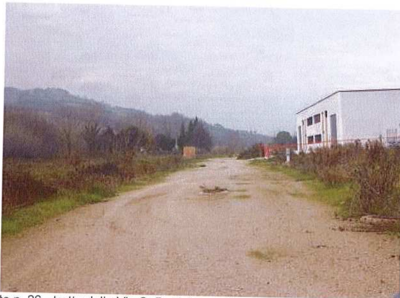
Foto n. 26 - tratto della Via S. Pertini non ultimato
