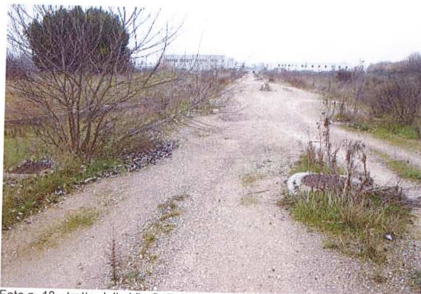
Foto n. 18 - tratto della Via S. Pertini non ultimato
