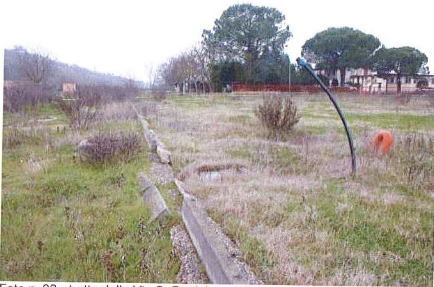
Foto n. 23 - tratto della Via S. Pertini non ultimato
