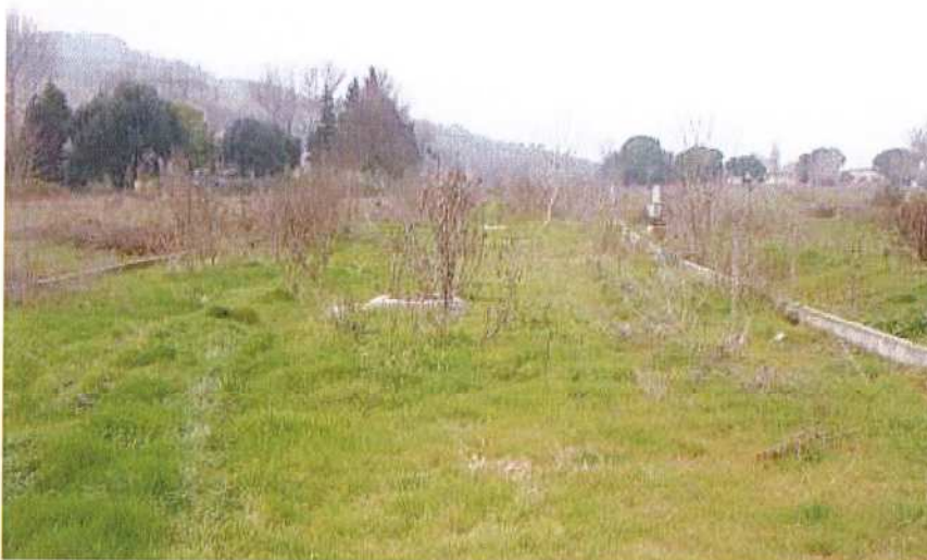
Foto n. 20 - tratto della Via S. Pertini non ultimato
