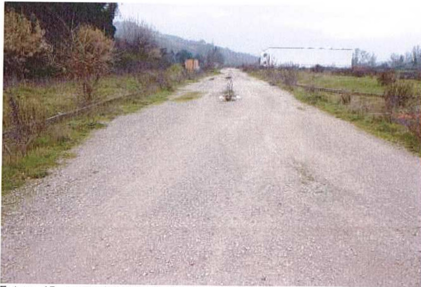
Foto n. 15 - tratto della Via S. Pertini non ultimato
