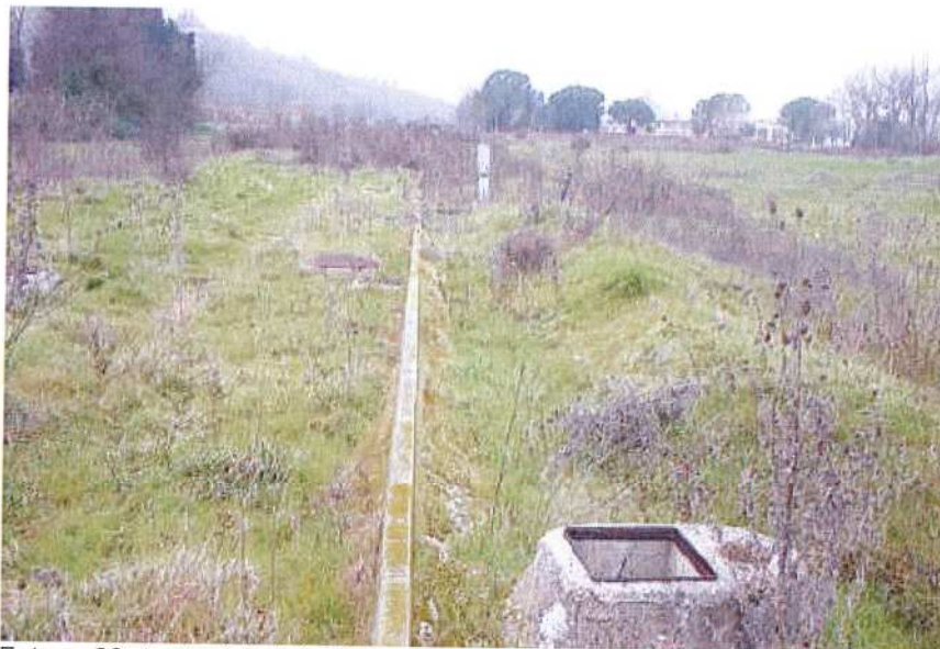
Foto n. 22- tratto della Via S. Pertini non ultimato
