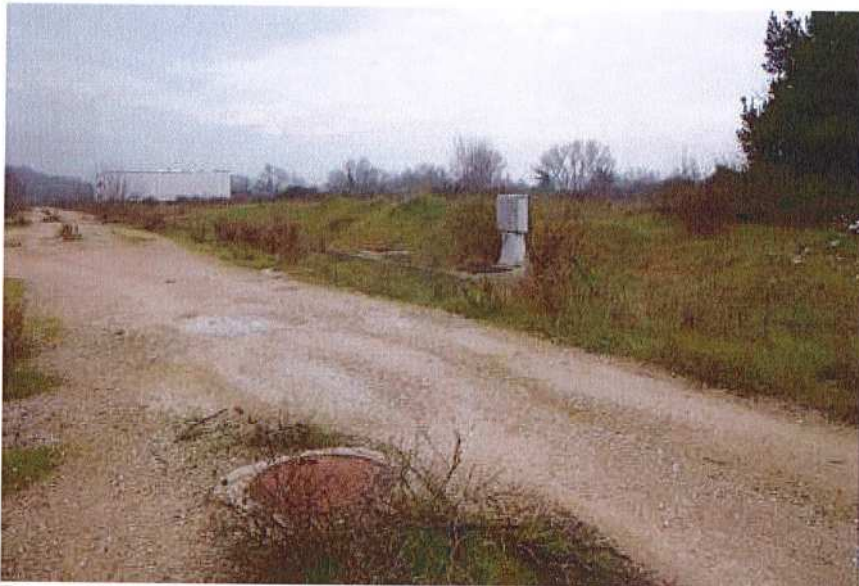
Foto n. 16 - tratto della Via S. Pertini non ultimato
