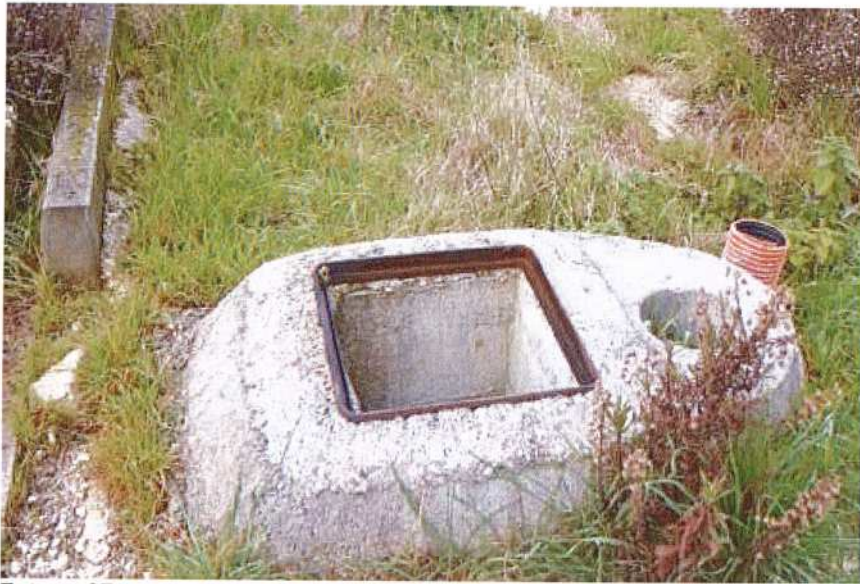
Foto n. 27 - opere eseguite nel tratto della Via S. Pertini non ultimato
