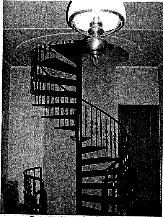
Foto 12. Scala di collegamento
