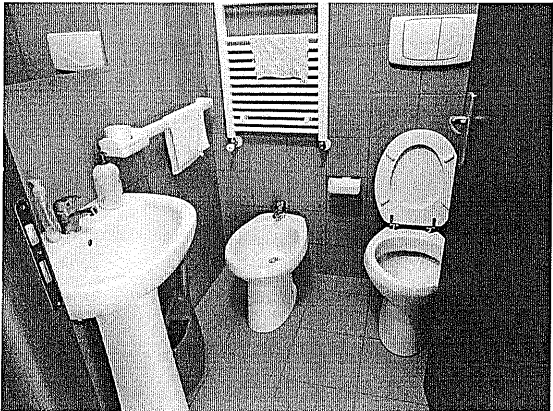
Foto 28 – Wc interno alla zona cucine del corpo di fabbrica – piano terra.
