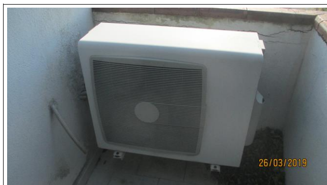
Foto 21. Particolare dell'unità esterna del sistema di condizionamento
