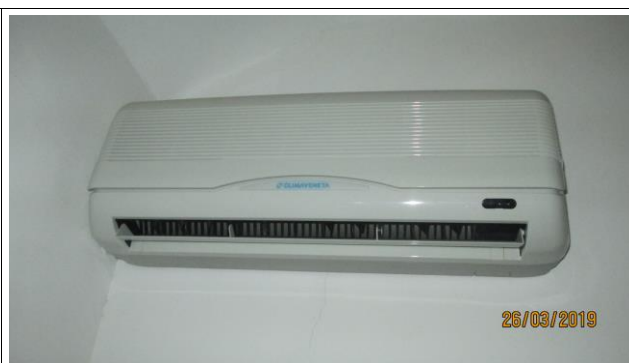
Foto 22. Particolare dell'unità interna (SPLIT) del sistema di condizionamento
