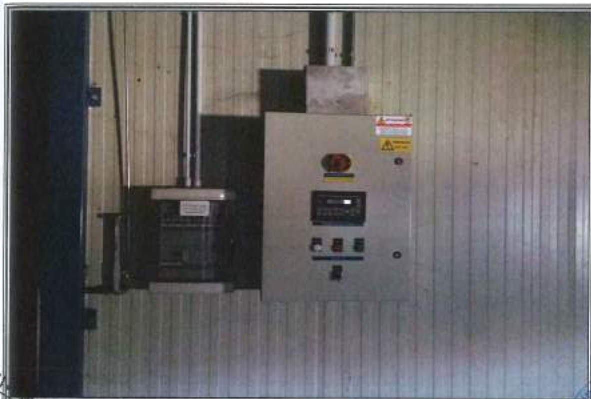
FOTOGRAFIA n. 9: Vista Interna Magazzini Frigoriferi (MF)
