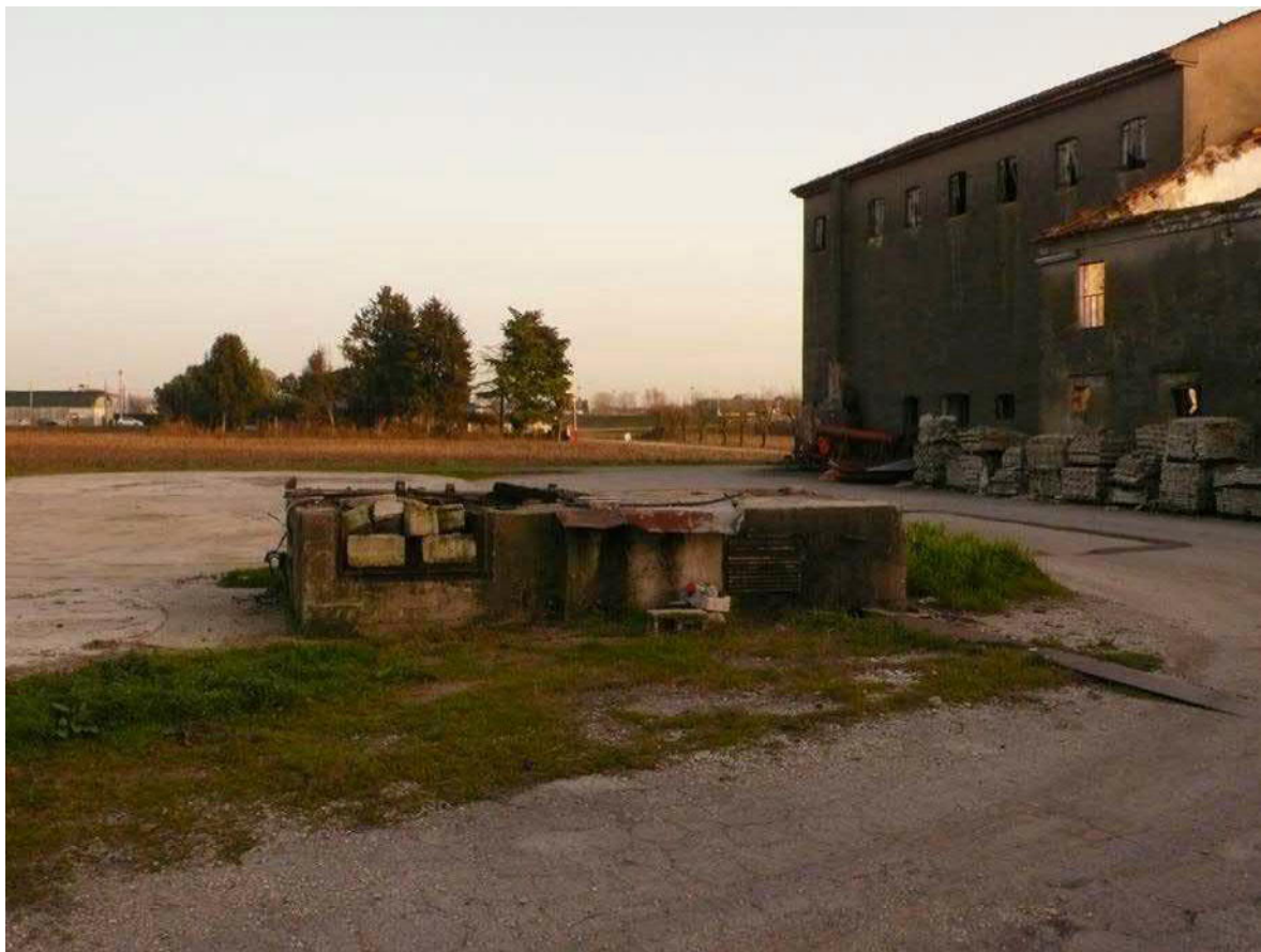
Foto n. 39 – “vasca molino” e “cabina elevatore” fatiscenti/diruti (mapp. 368/sub.1)
