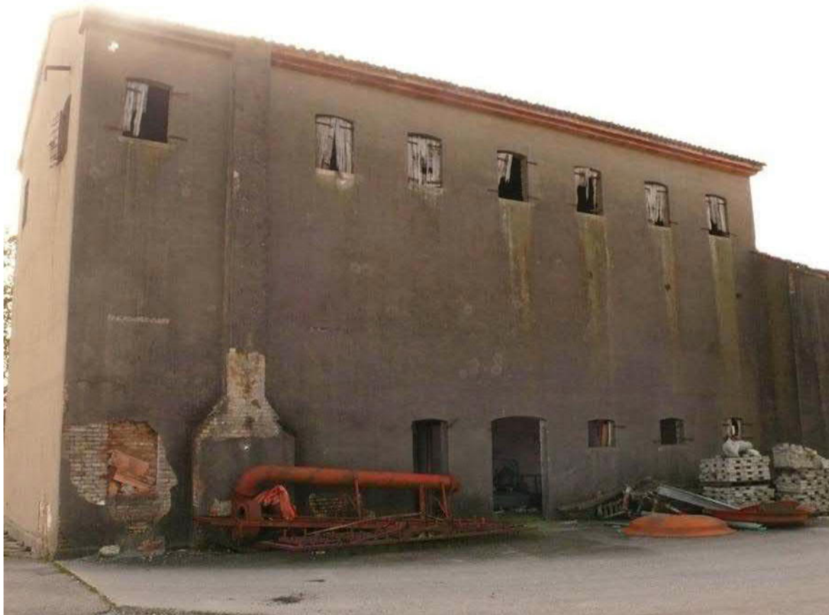
Foto n. 45 – fabbricato diruto (mapp. n. 14)
