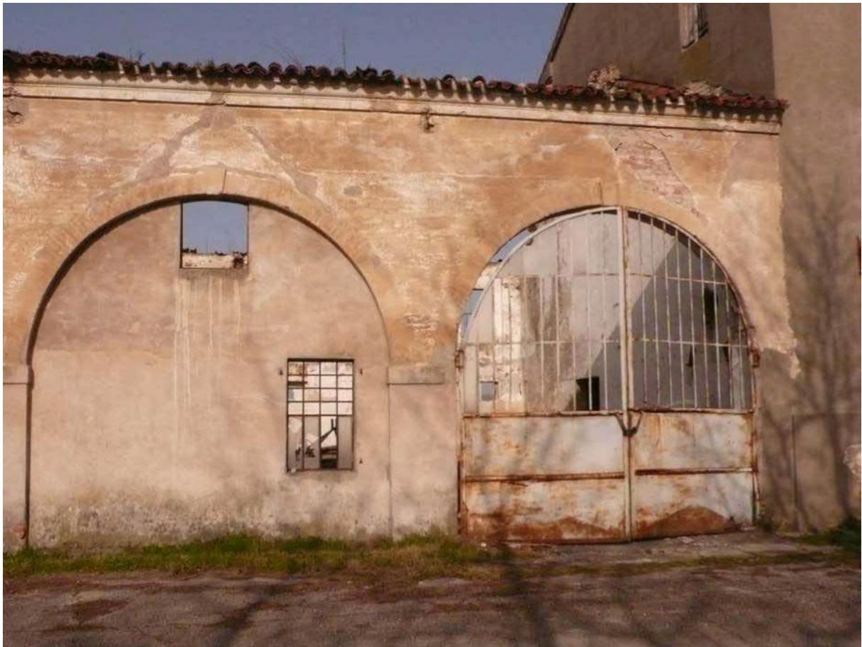
Foto n. 50 – fabbricato diruto (mapp. n. 14)
