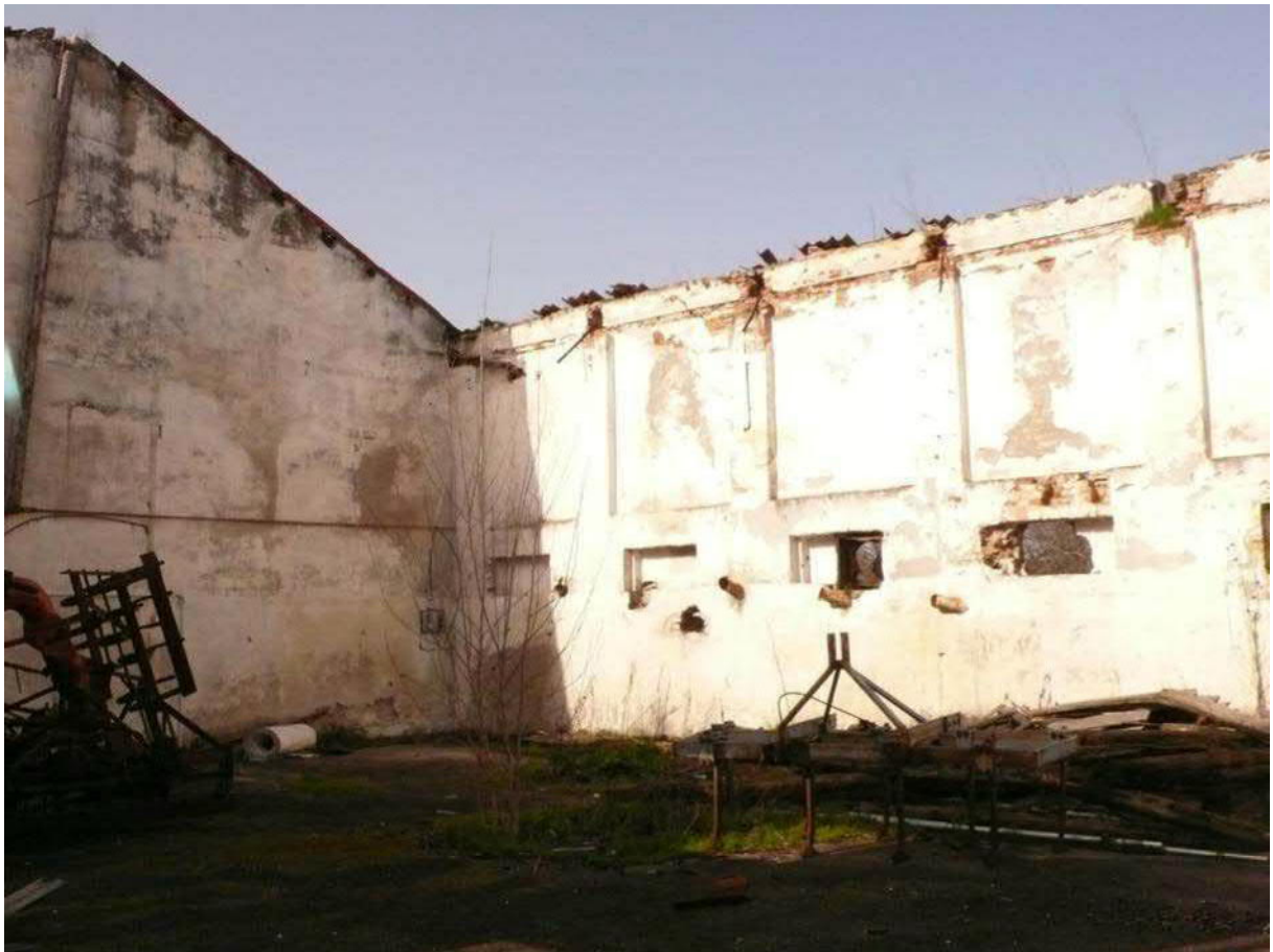
Foto n. 49 – fabbricato diruto (mapp. n. 14)
