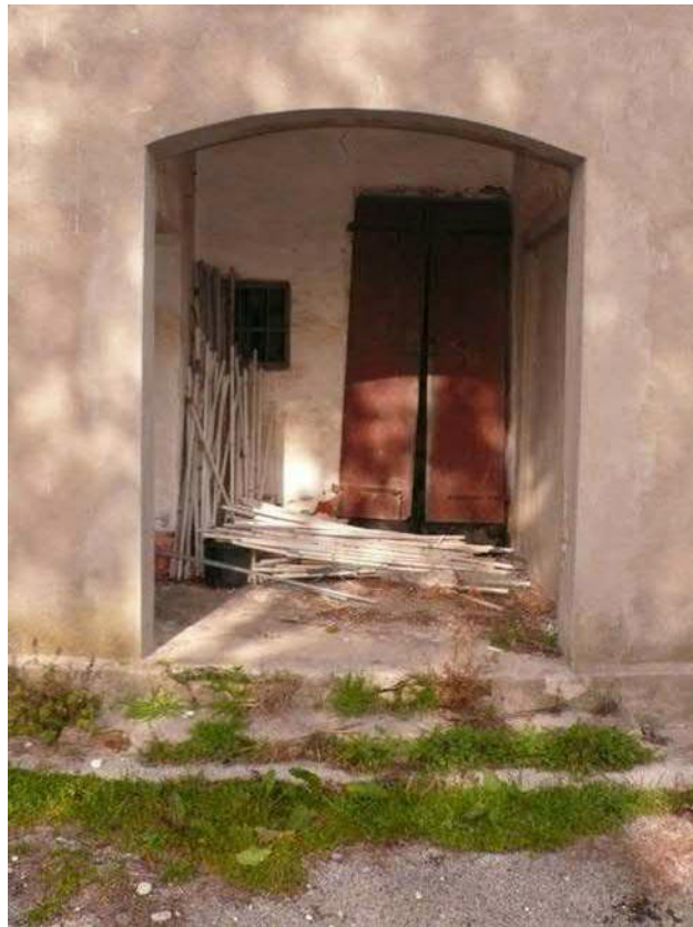
Foto n. 44 – fabbricato diruto (mapp. n. 14)
