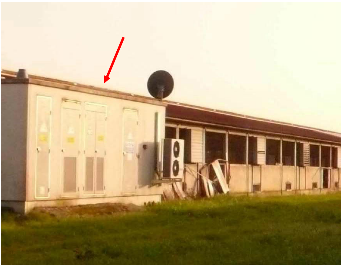
Foto n. 41 – cabina elettrica (mapp. 368/sub. 2)
