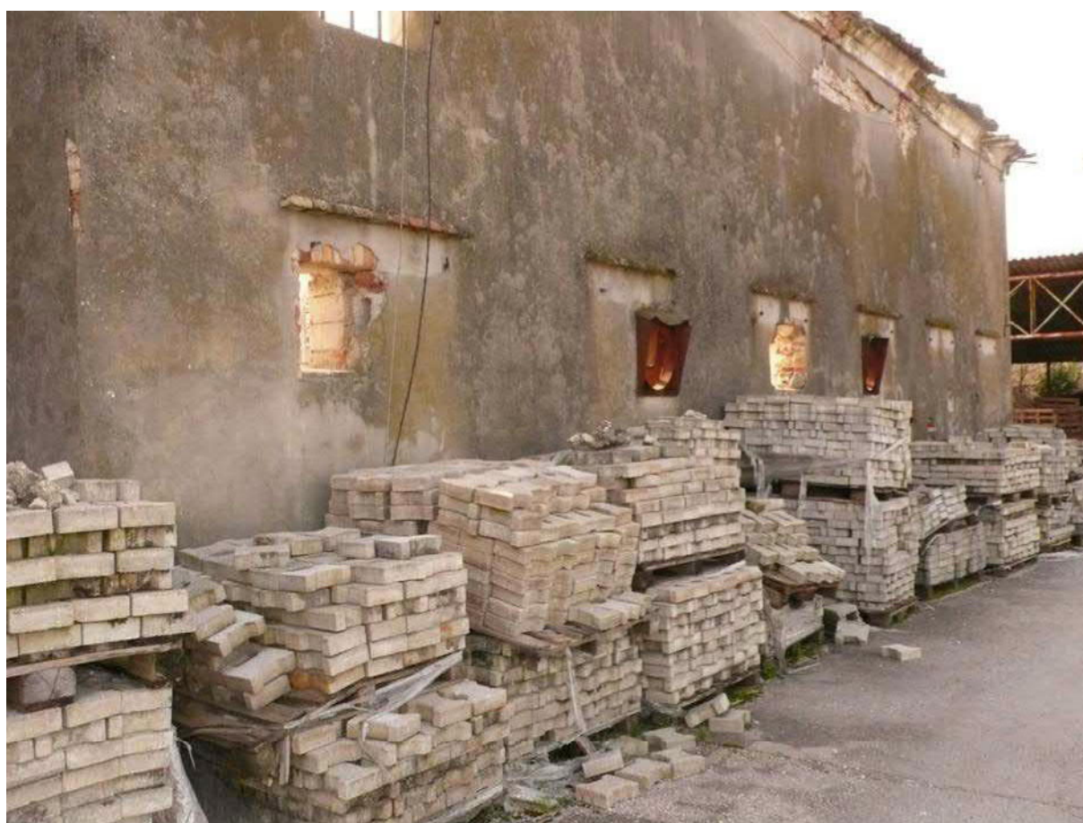
Foto n. 46 – fabbricato diruto (mapp. n. 14)
