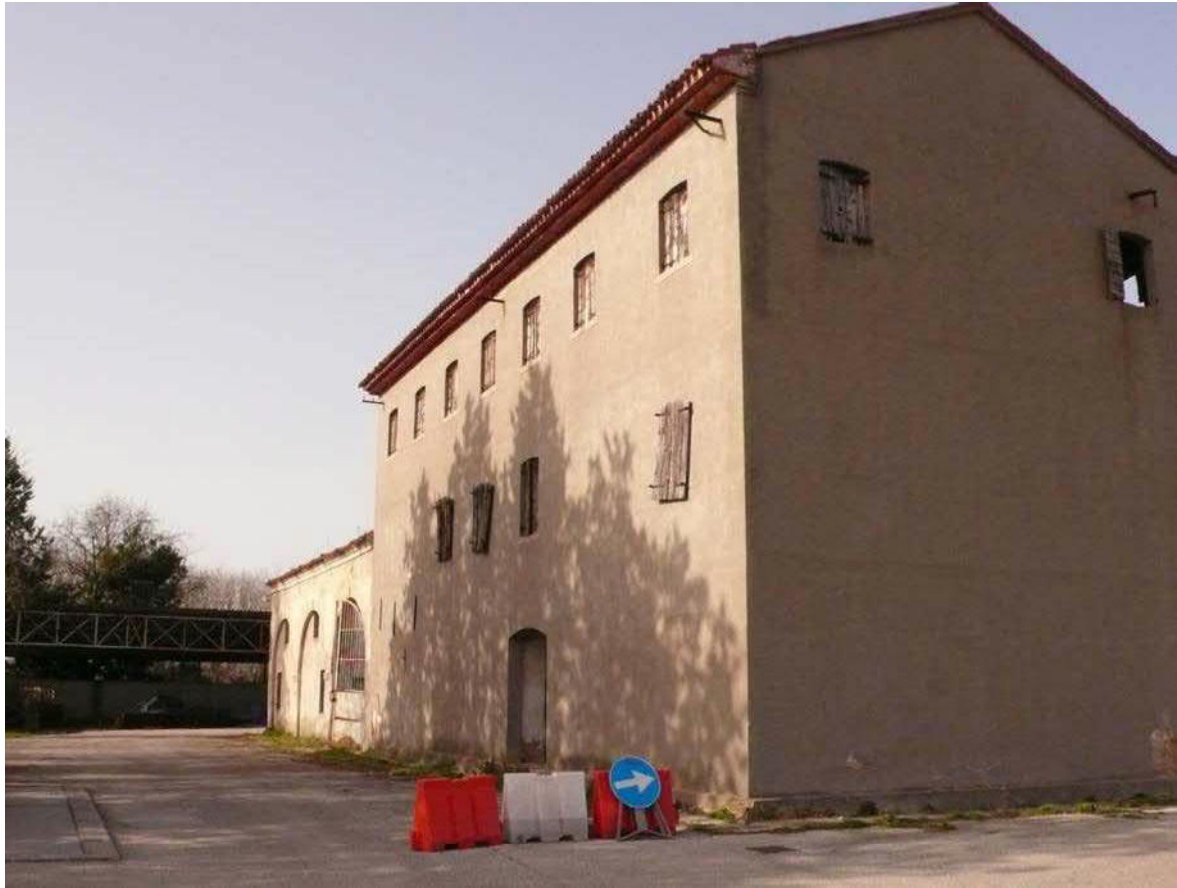
Foto n. 43 – fabbricato diruto (mapp. n. 14)
