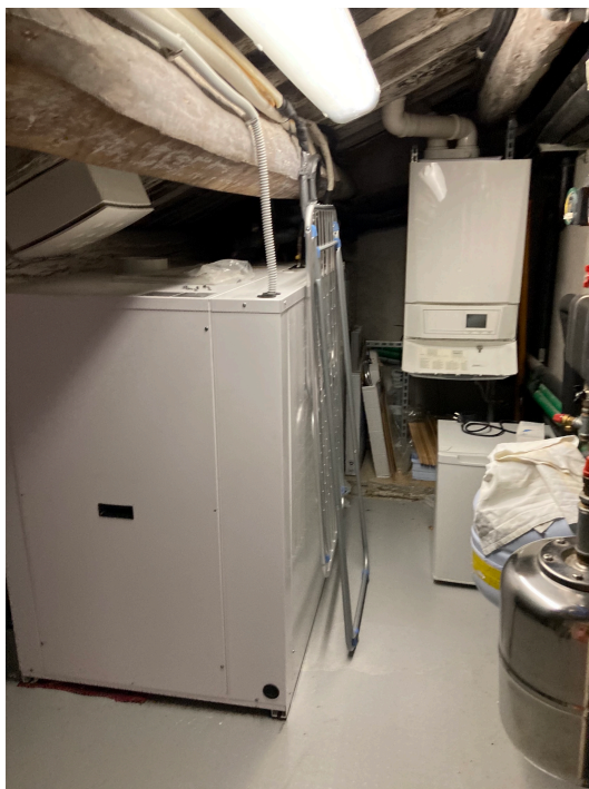
Foto interna – P3 vano tecnico
