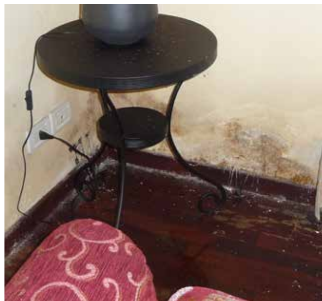
Degrado e muffa alle pareti
