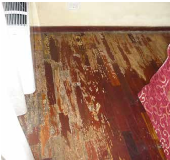
Pavimento in legno in evidente stato di degrado
