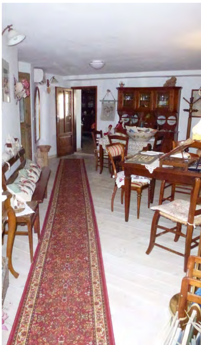
Ingresso piano terra, parete sulla sinistra non regolare
