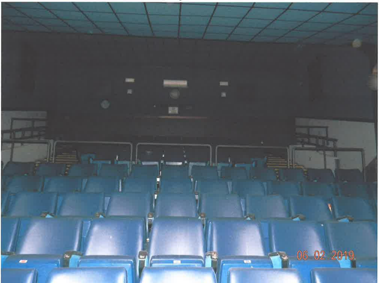
Fabbricato da cielo a terra – Vista interna: galleria verso cabina di proiezione
