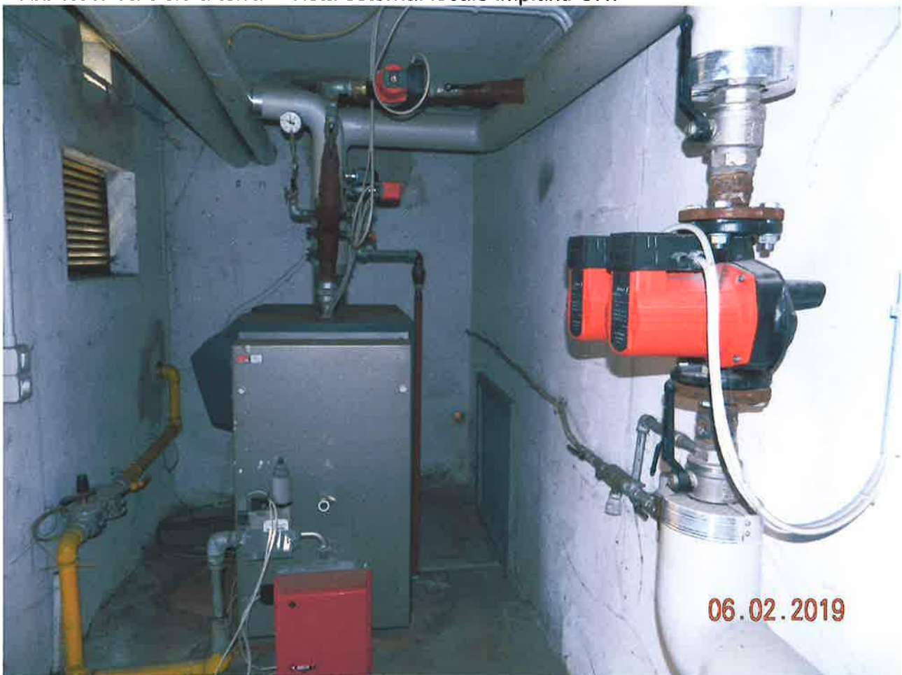
Fabbricato da cielo a terra – Vista interna: centrale termica
