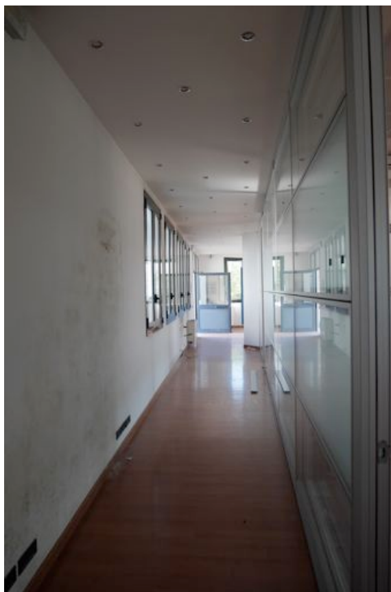
FOTO 8 - Il corpo ad uso uffici. Piano terra. Il corridoio verso l'ingresso. Sulla sinistra si notano le macchie infiltrative sul muro che divide il corridoio con la scala di accesso all'ufficio al piano primo.
