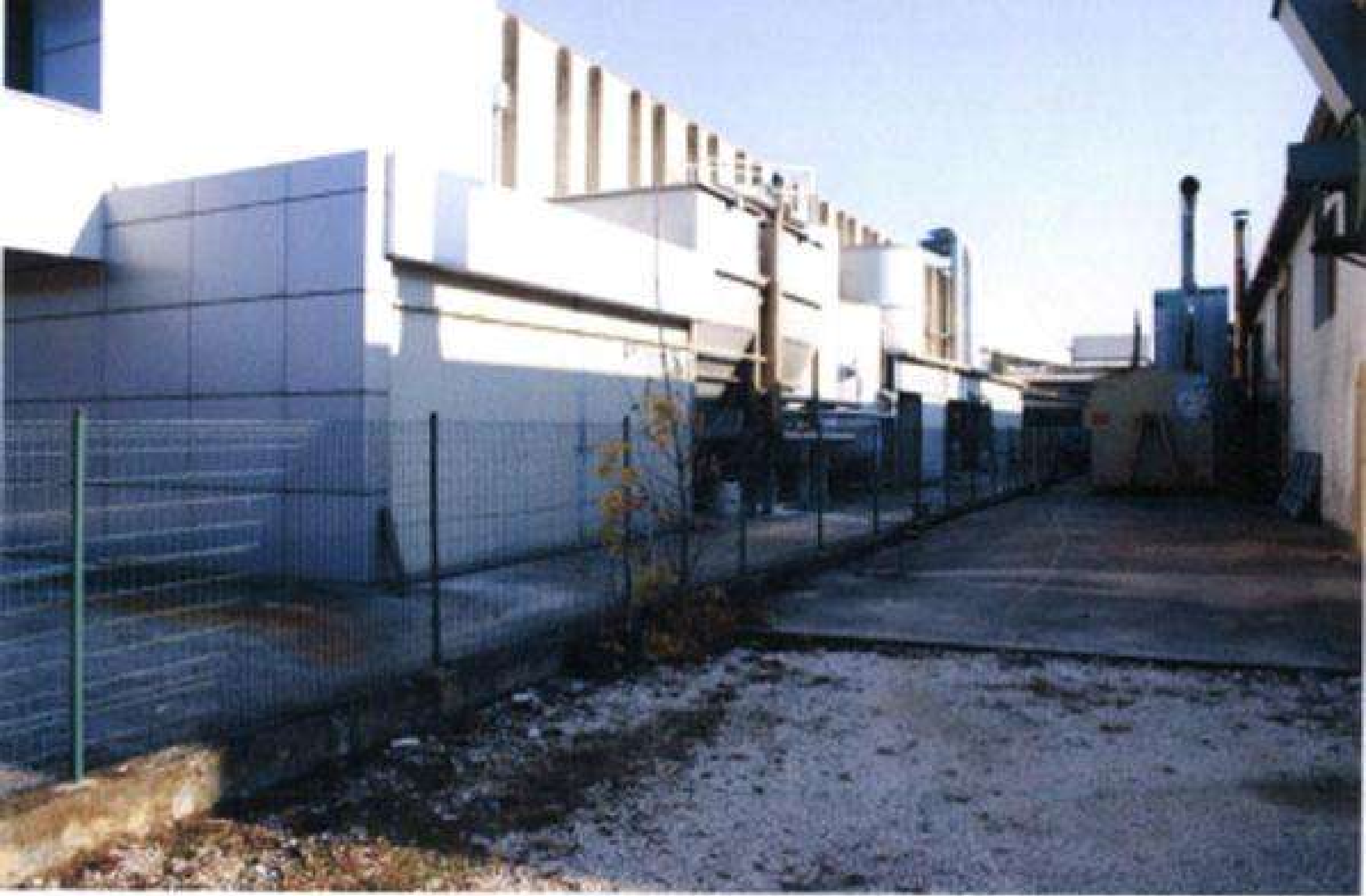
3 fronte sud corpo B (laboratorio) - impianti tecnici
