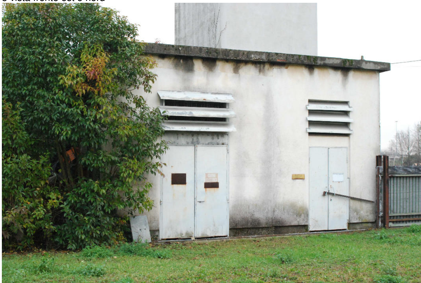
6 vista cabina MT (sub.6) e cabina ENEL (dietro)
