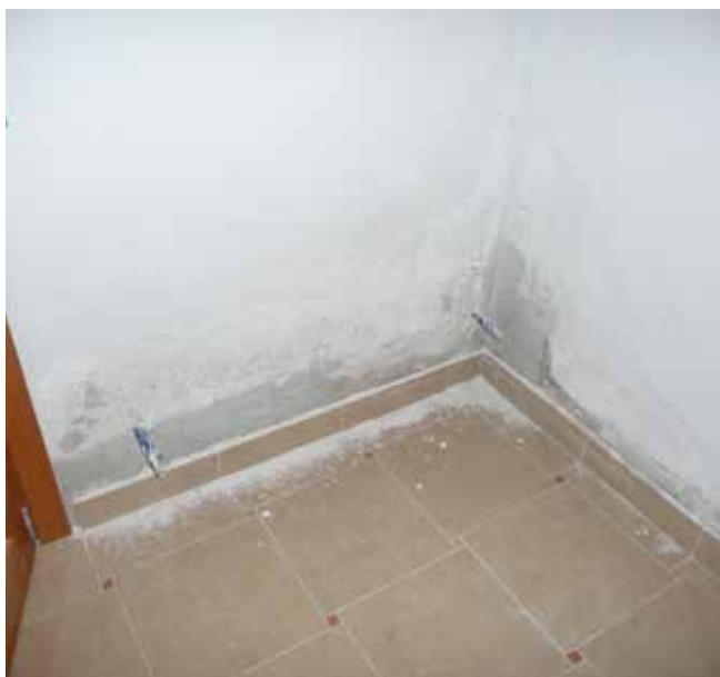
Particolare muri con presenza di umidità
