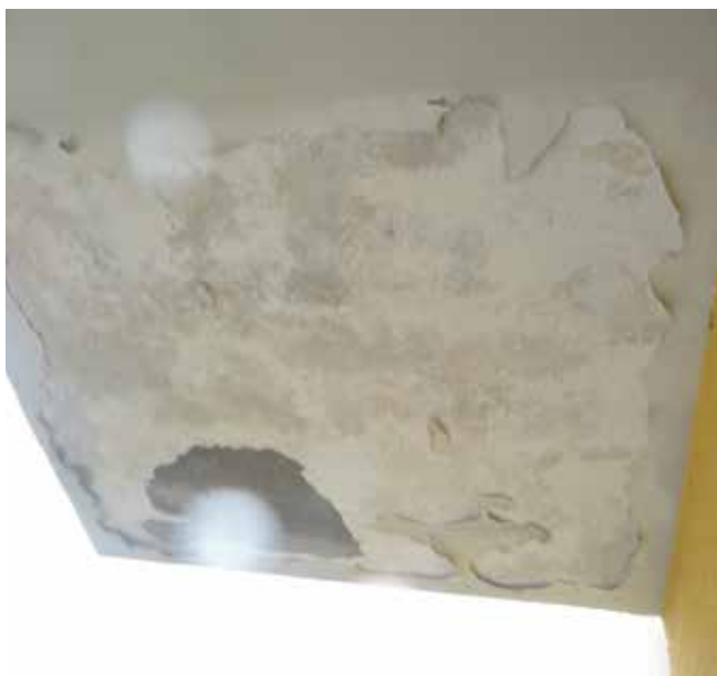
Vista solaio terrazze con distacco intonaco
