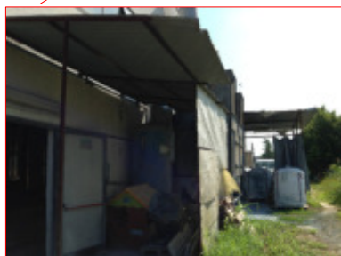
(2) Tettoia in lamiera abusiva
