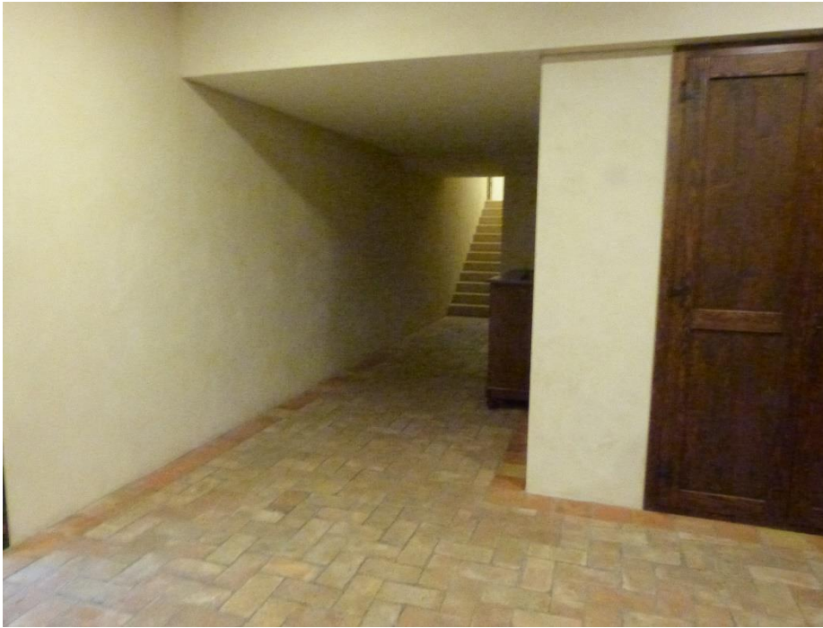
45 Ampliamento interrato – corridoio abusivo di collegamento tra l'ampliamento e la villa.
