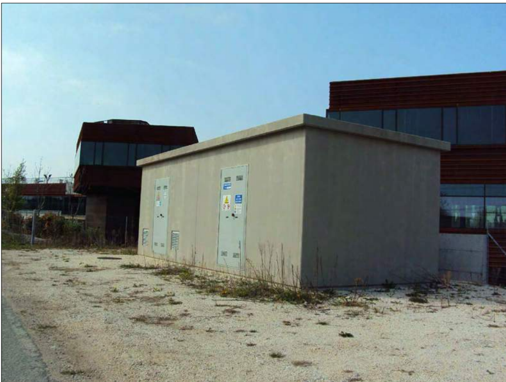
Foto n. 142: Cabina elettrica vista da via Talpon
