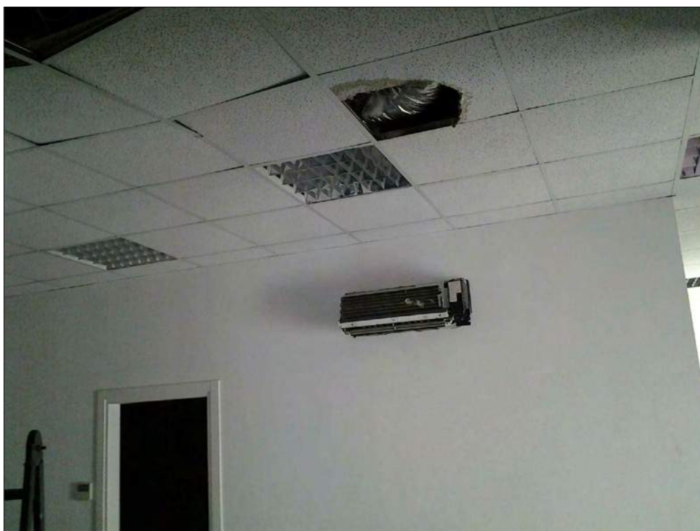
Foto n. 84: Locali ad uso commerciale al primo piano, oggetto di atti vandalici
