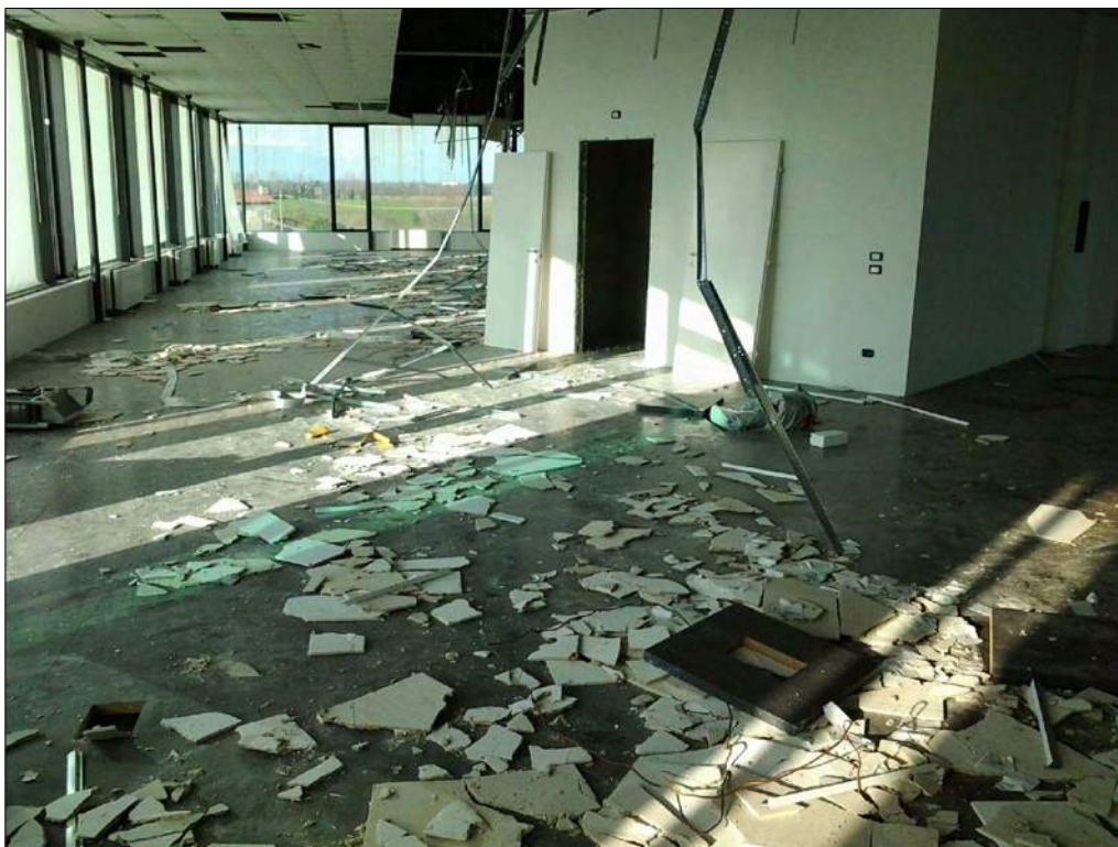
Foto n. 89: Locale ad uso industriale-artigianale al primo piano lato EST, oggetto di atti vandalici
