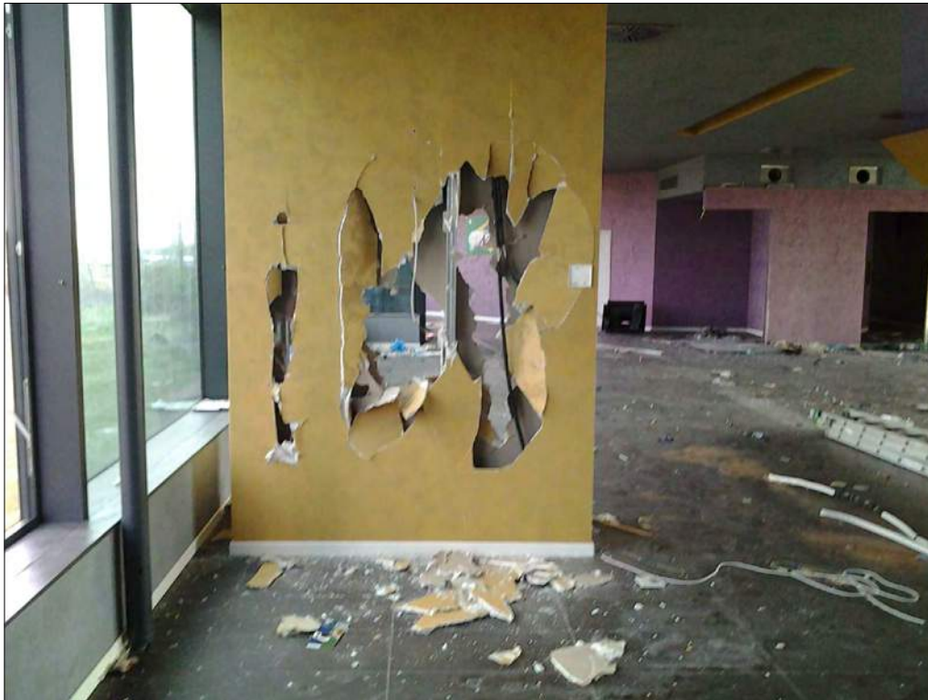
Foto n. 81: Locali ad uso commerciale al primo piano, oggetto di atti vandalici
