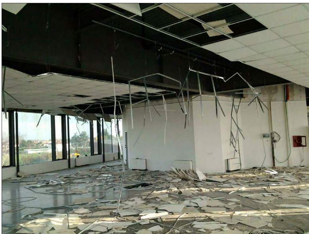
Foto n. 86: Locale ad uso industriale-artigianale al primo piano lato EST, oggetto di atti vandalici
