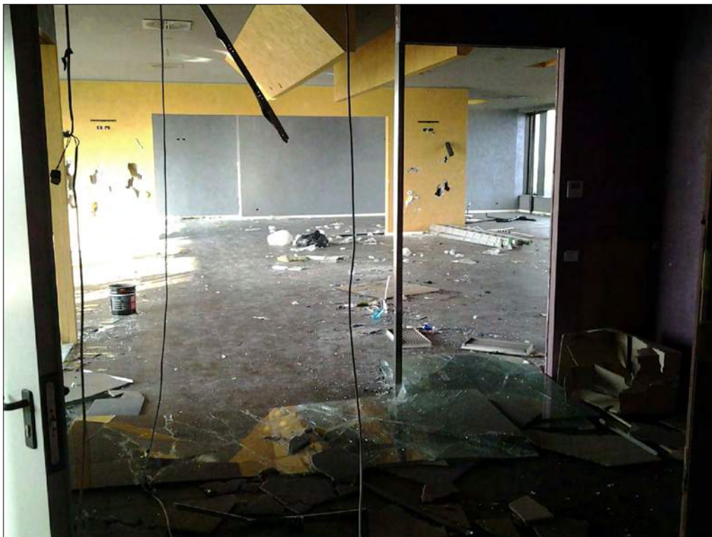
Foto n. 80: Locali ad uso commerciale al primo piano, oggetto di atti vandalici
