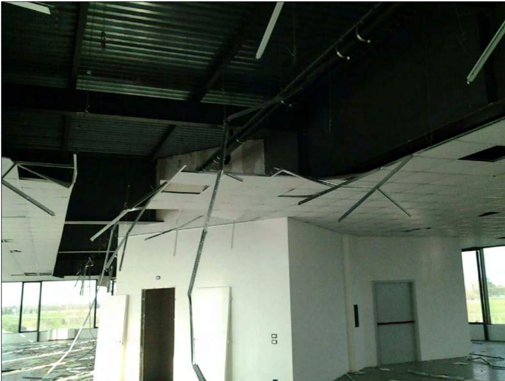
Foto n. 88: Locale ad uso industriale-artigianale al primo piano lato EST, oggetto di atti vandalici
