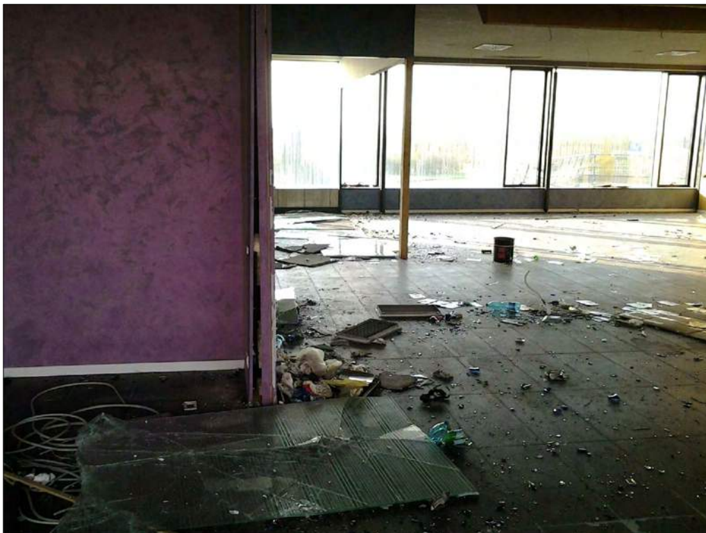
Foto n. 82: Locali ad uso commerciale al primo piano, oggetto di atti vandalici
