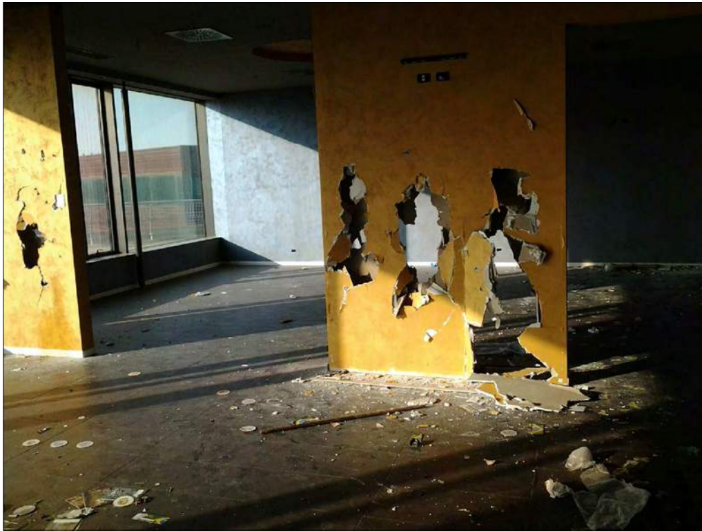
Foto n. 79: Locali ad uso commerciale al primo piano, oggetto di atti vandalici
