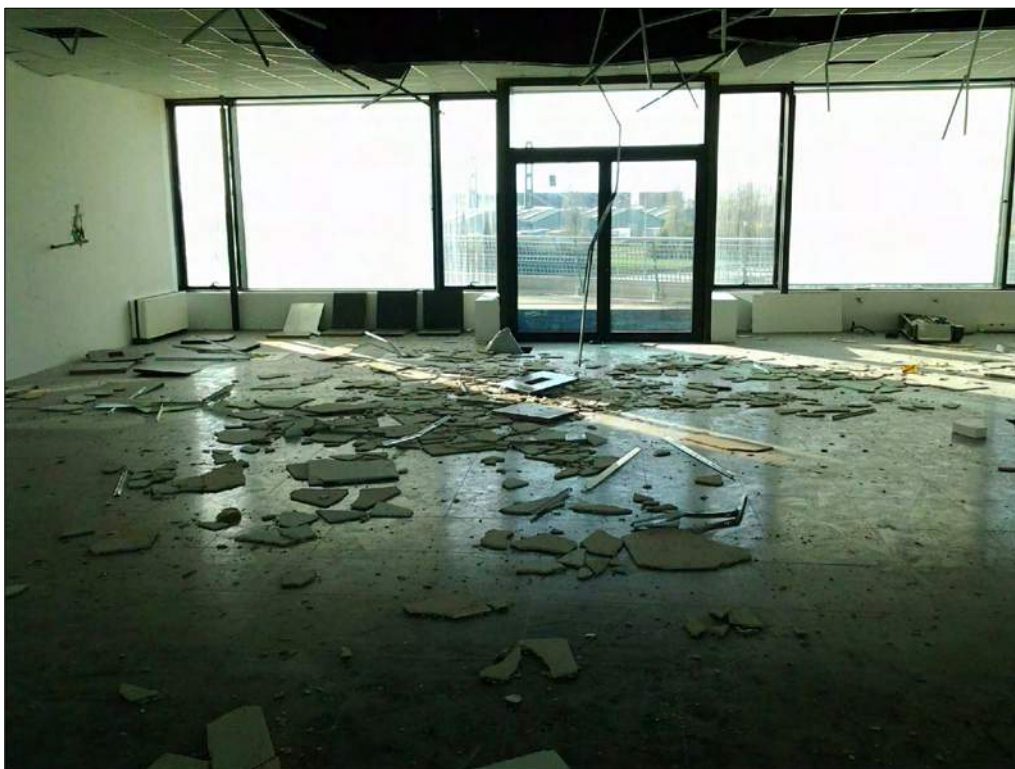
Foto n. 90: Locale ad uso industriale-artigianale al primo piano lato EST, oggetto di atti vandalici
