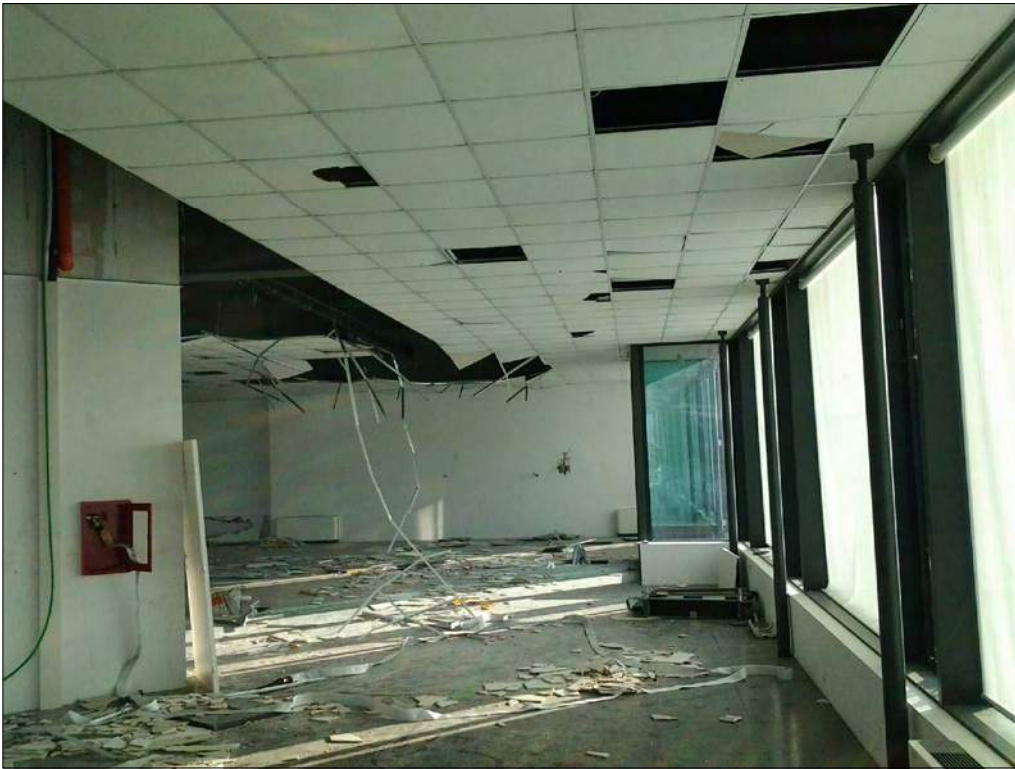
Foto n. 87: Locale ad uso industriale-artigianale al primo piano lato EST, oggetto di atti vandalici
