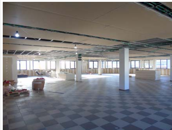
Vista vano sub. 20
