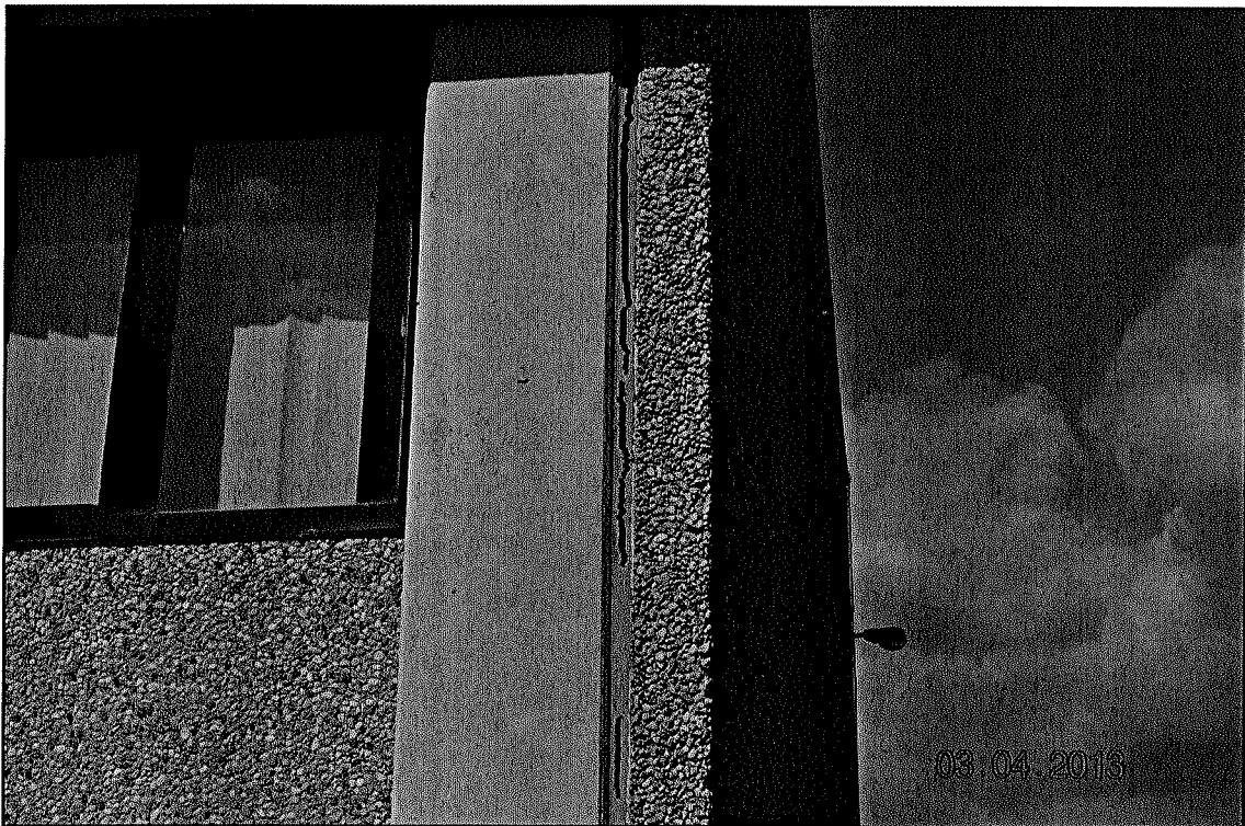
Figura 2. Spostamento verso l'esterno della parete di tamponamento prefabbricata.
