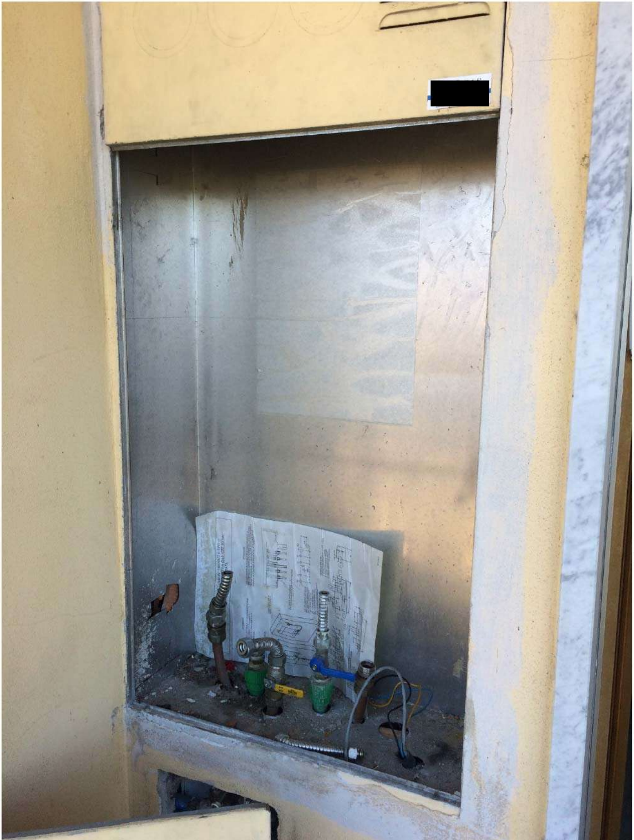
Foto 25 – Balcone (alloggio caldaia)
