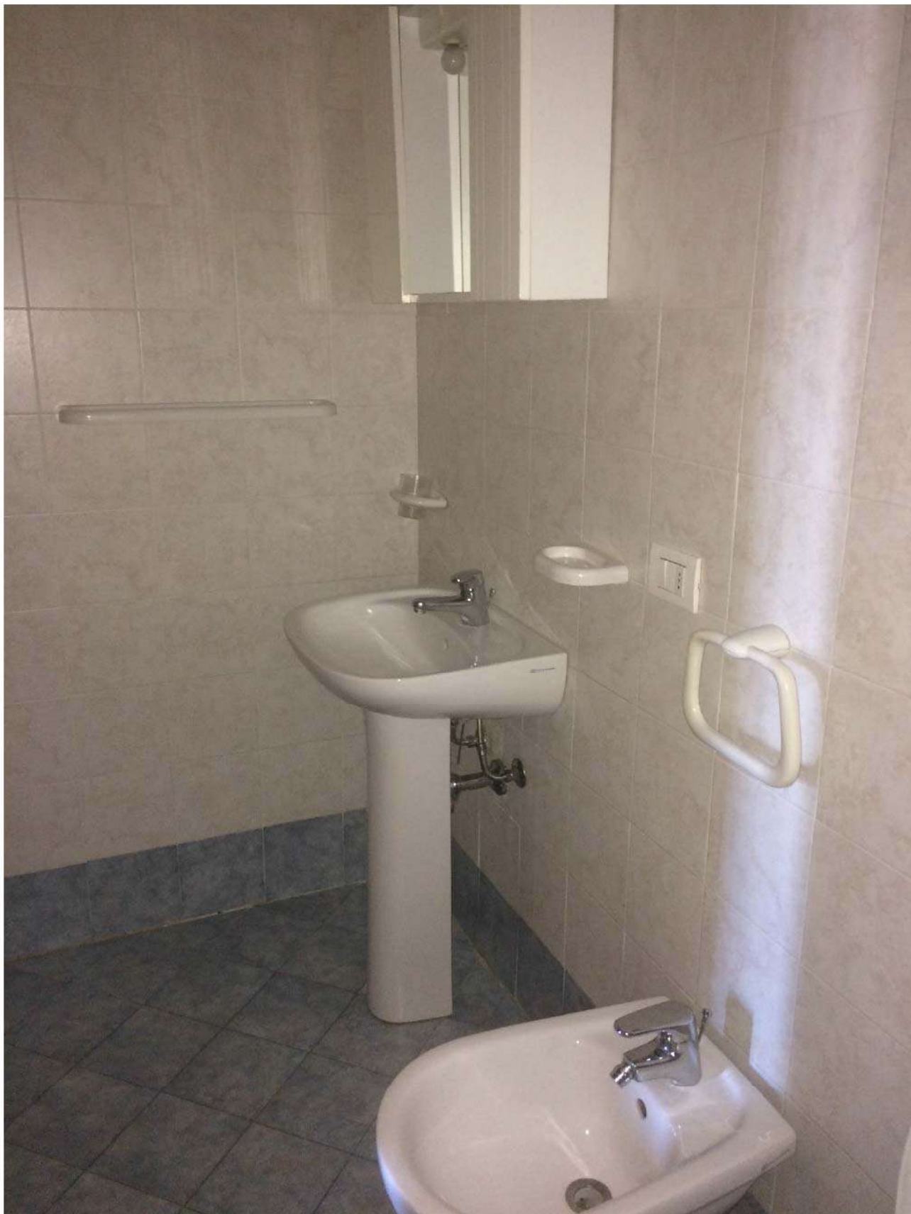
Foto 21 – Bagno con doccia
