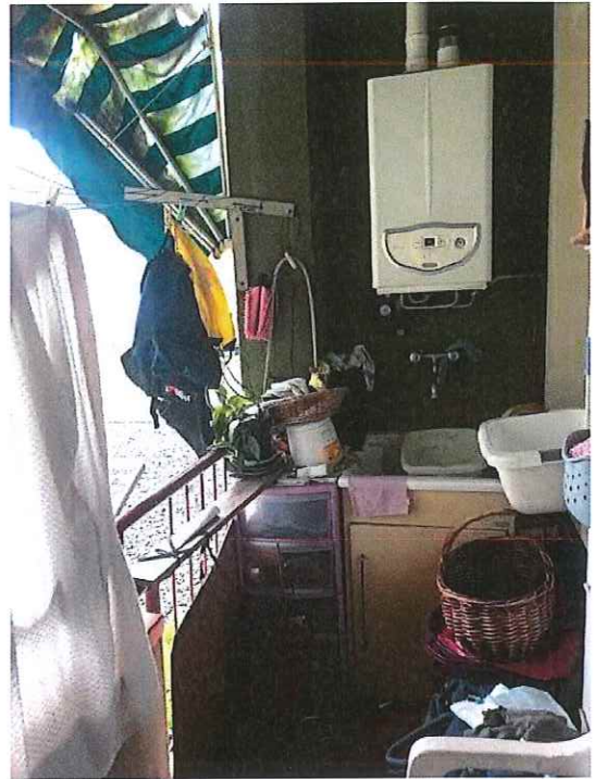
Terrazza a ovest (caldaia)
