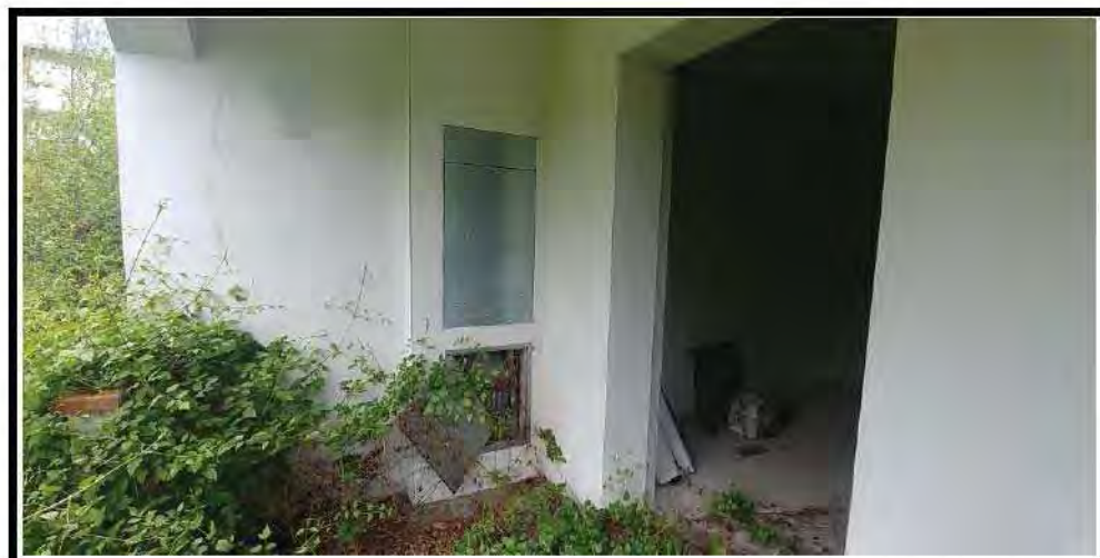
Foto n. 8 – Particolare alloggiamento caldaia, collettore riscaldamento
