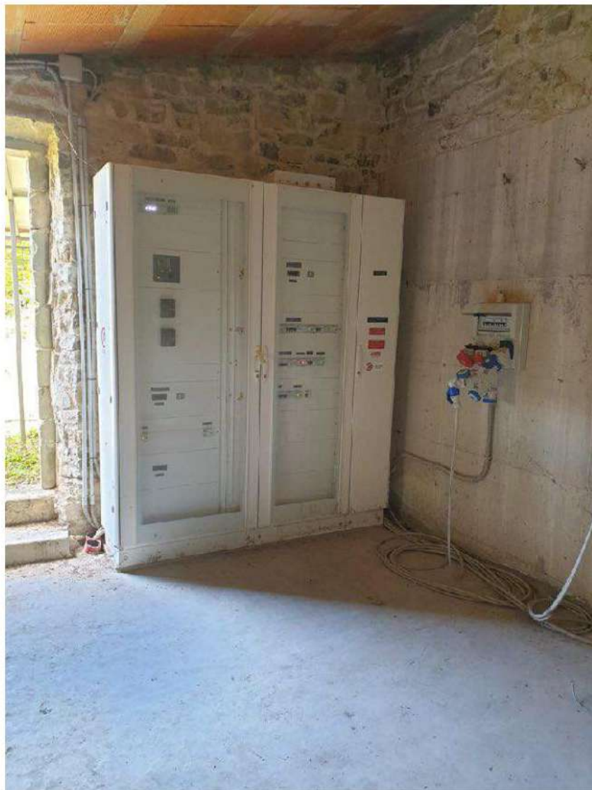
Foto 219. Interno del locale tecnico esterno al castello
