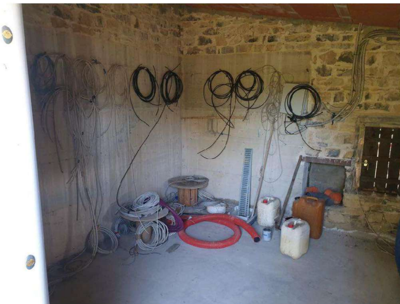
Foto 218. Interno del locale tecnico esterno al castello
