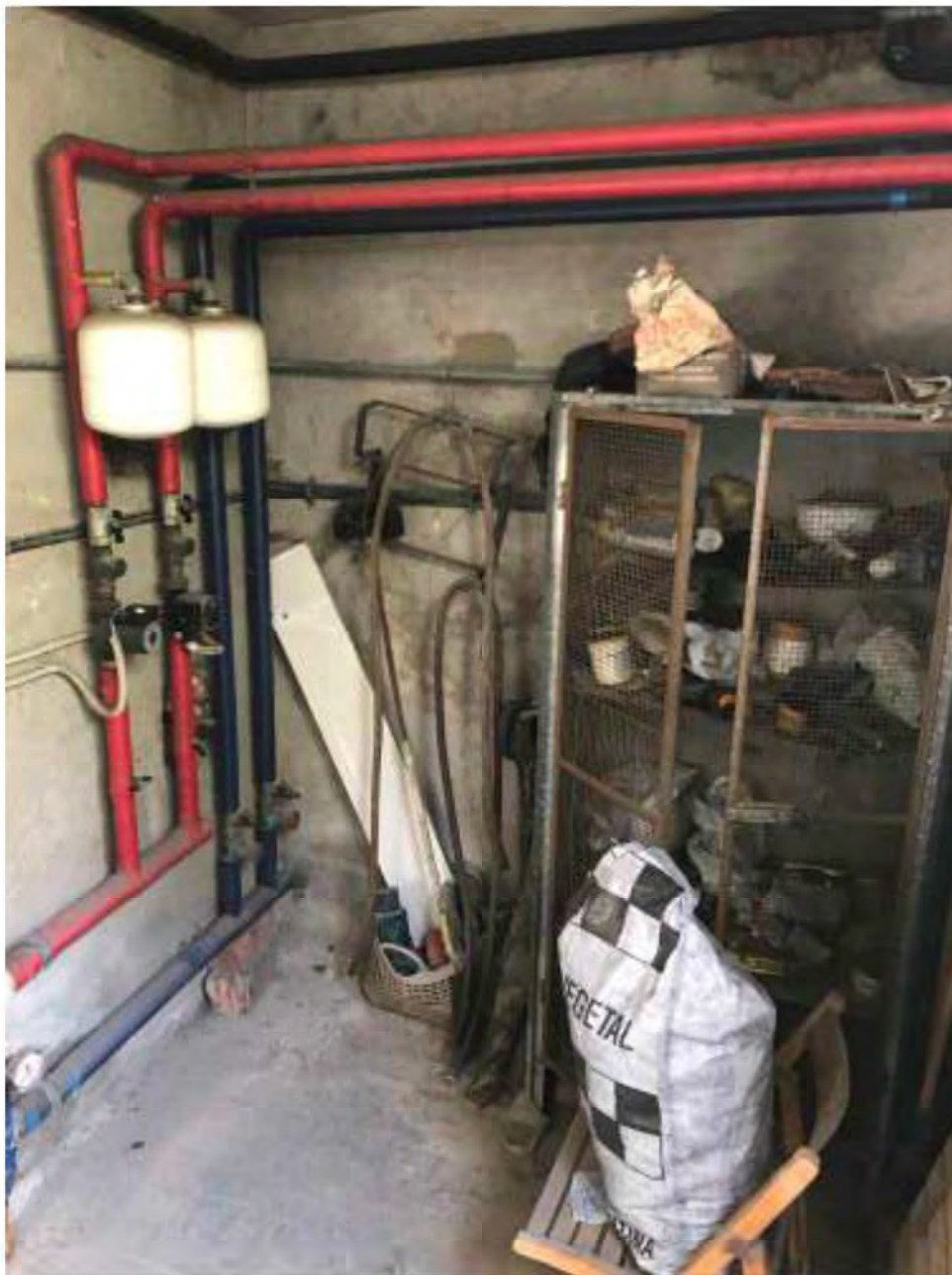
Foto 1: Marina di Massa, Massa. Lotto 001. Centrale Termica.
