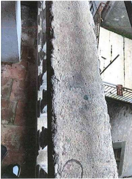
Particolare del parapetto deteriorato
