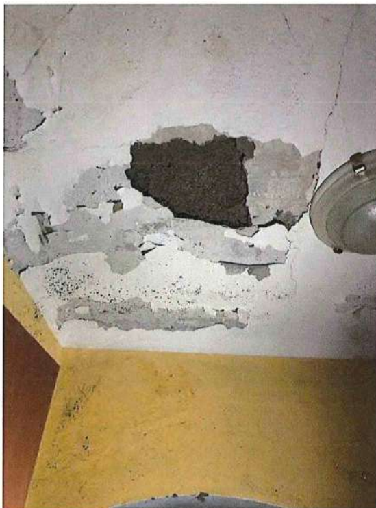
Particolare delle gravi infiltrazioni sul soffitto
