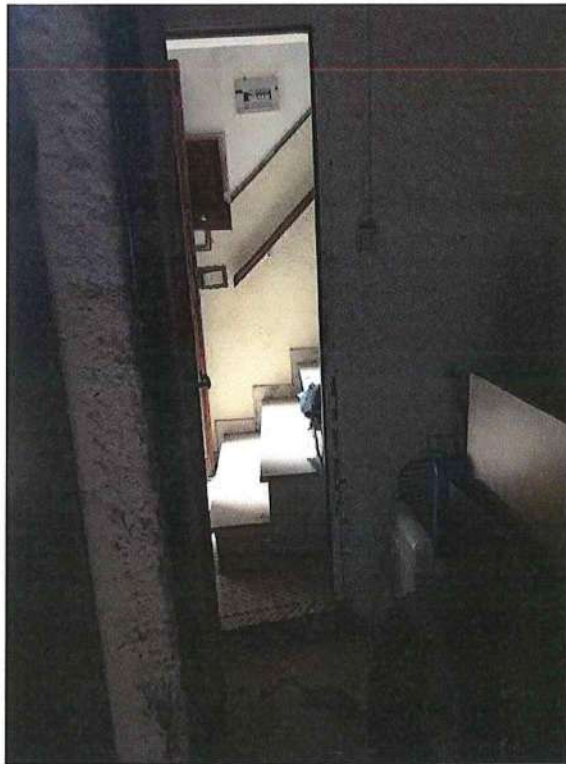
Porta di comunicazione fra i locali cantine e il disimpegno di ingresso all'abitazione
