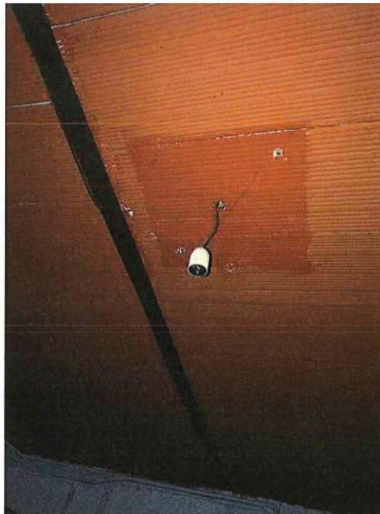
Particolare del solaio di copertura del Piano Terra, in tavelloni e ferro di recente realizzazione
