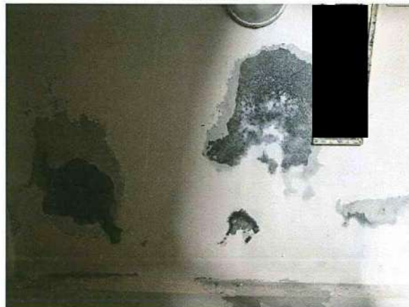
Presenza di infiltrazioni di umidità
