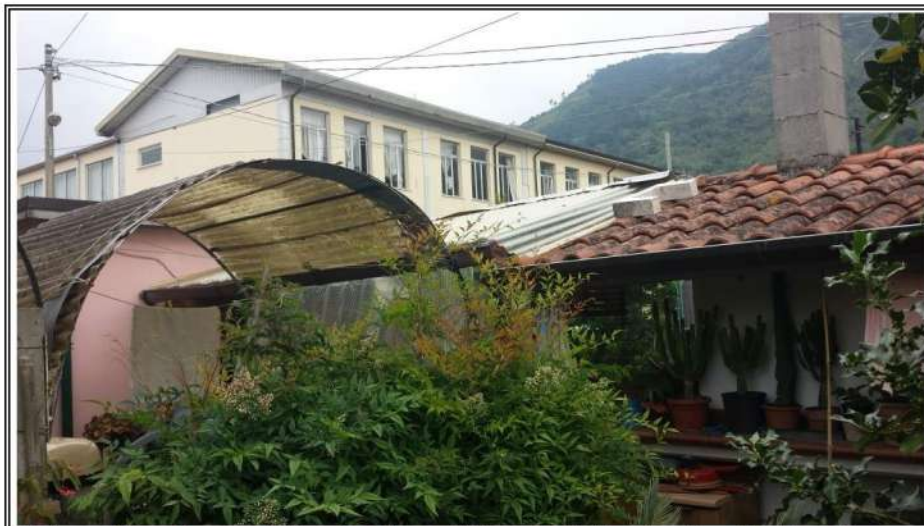
Foto n. 12 – Garage PT – fg 61 m 690/3 – Tettoie abusive da demolire
