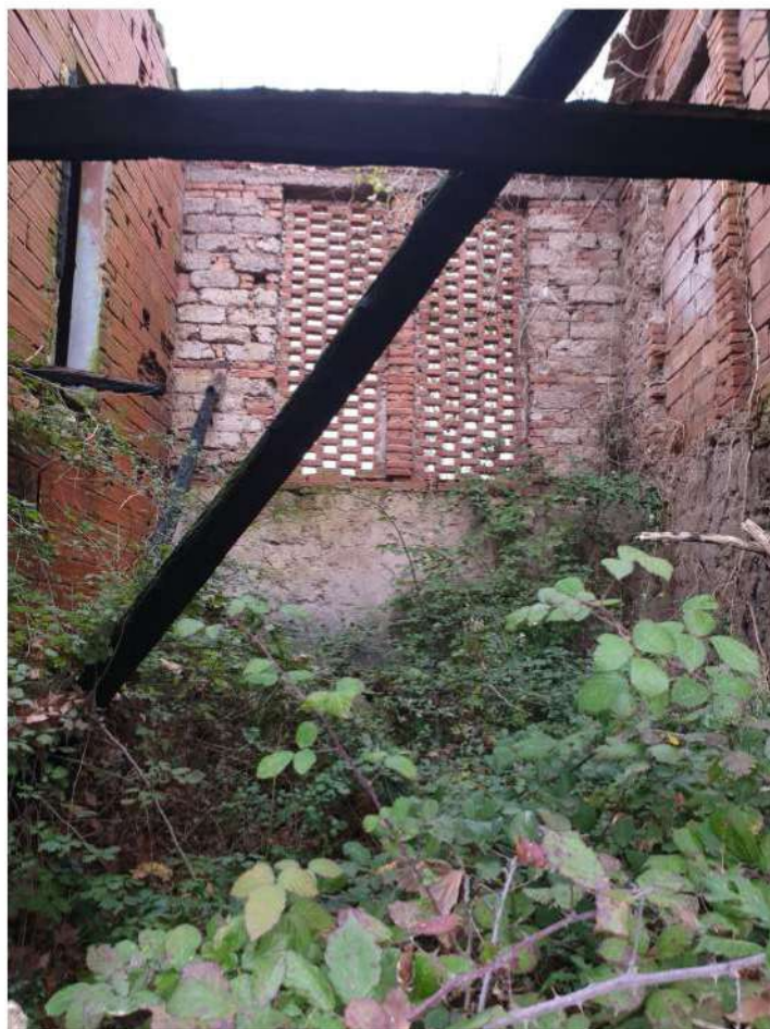
Foto 8. Interno: vecchia cantina e ripostiglio con solaio distrutto
