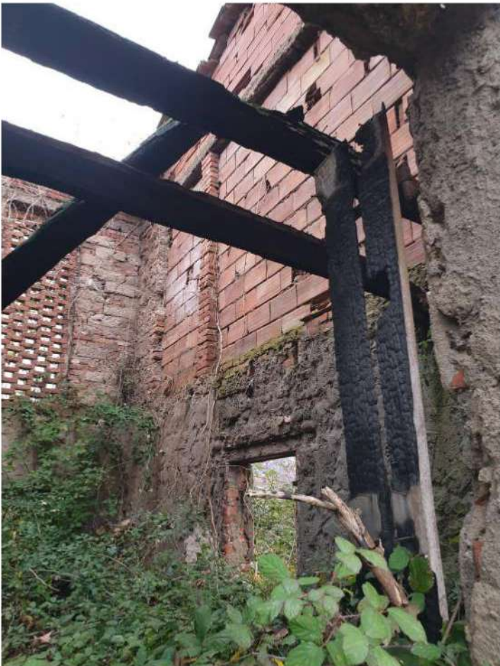
Foto 8-9-10. Interno: vecchia cantina e ripostiglio con solaio distrutto
