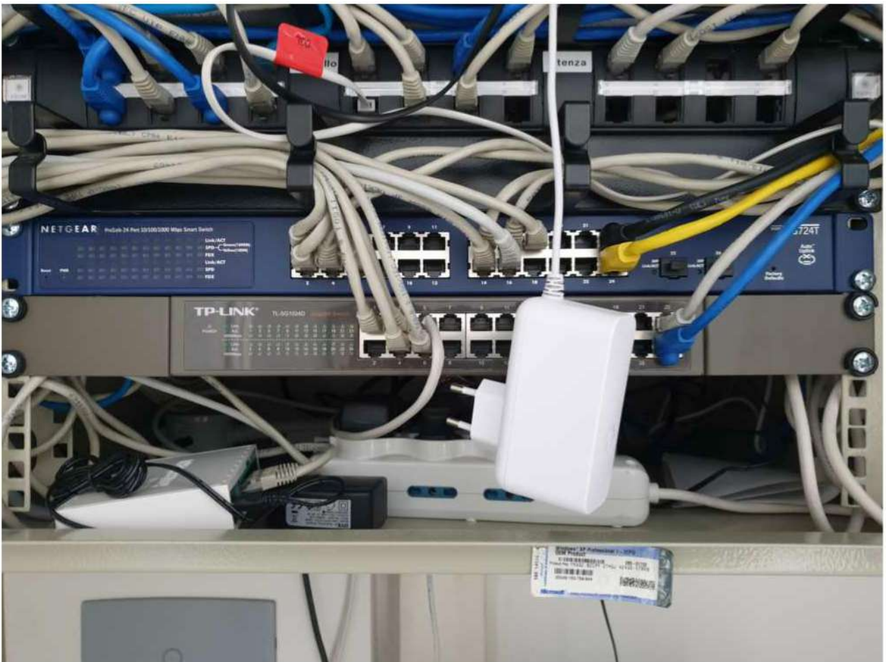
Foto 23 e 24. Ufficio 1, rastrelliera informatica (rack) composto da Fireworlds marca Netgear ProSafe 24 porte (Model GS724T), Switch marca TP-LINK modello TL-SG1024D, pannello telefonico e n°6 prese universali
