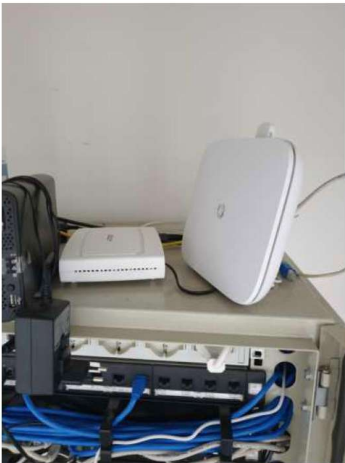
Foto 15. Ufficio 1, modem wifi e modem Vodafone
