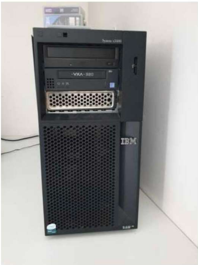
Foto 17. Ufficio 1, server di sistema
