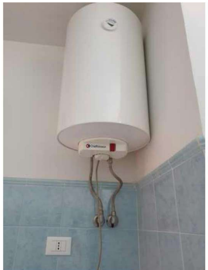
Foto 39. Bagno, boiler Chaffoteaux
