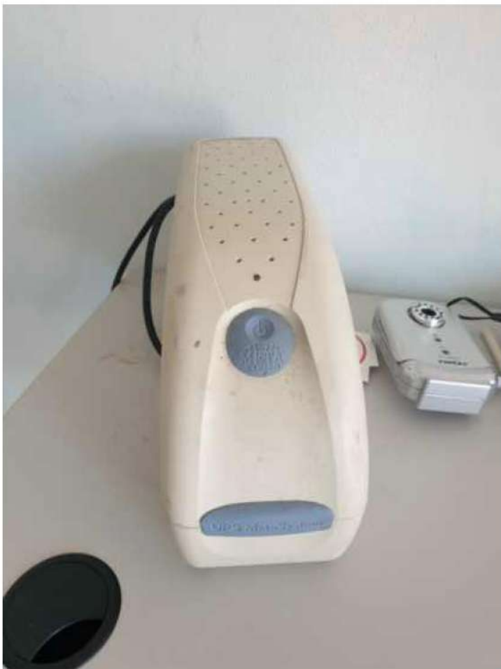
Foto 9. Ingresso, gruppo di continuità Matasystem
