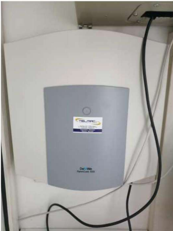
Foto 25. Ufficio 1, centralina telefonica marca Detewe Opencom 100
