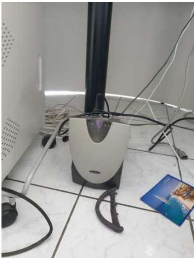
Foto 6. Ingresso, gruppo di continuità Belkin
