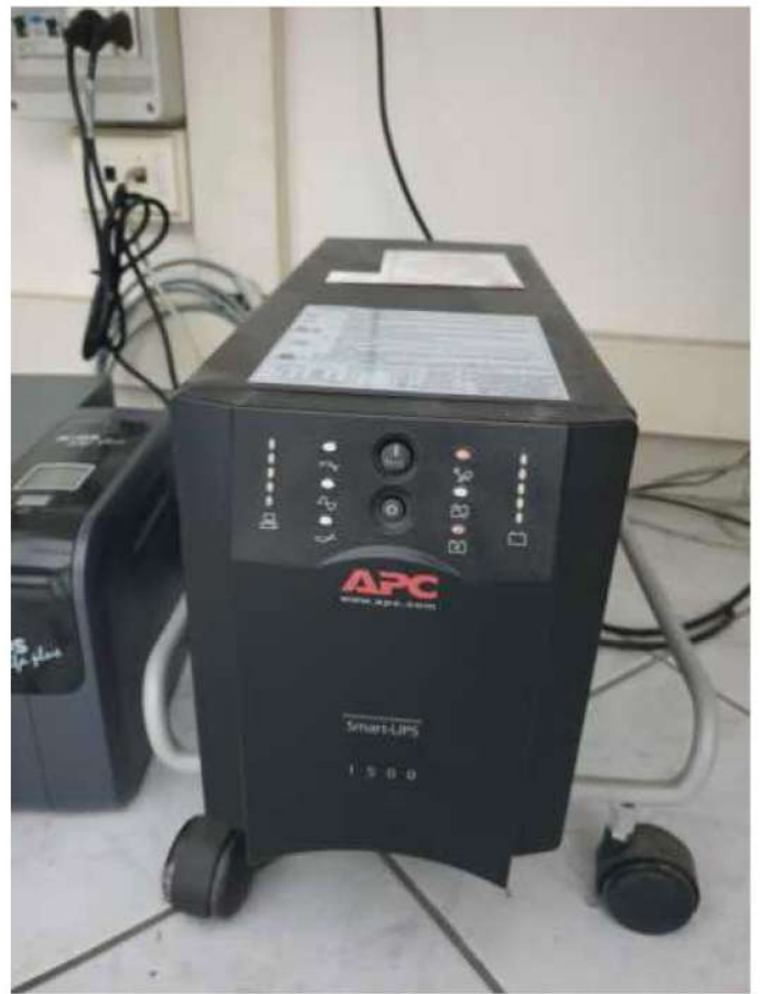
Foto 20. Ufficio 1, gruppo di continuità APC
