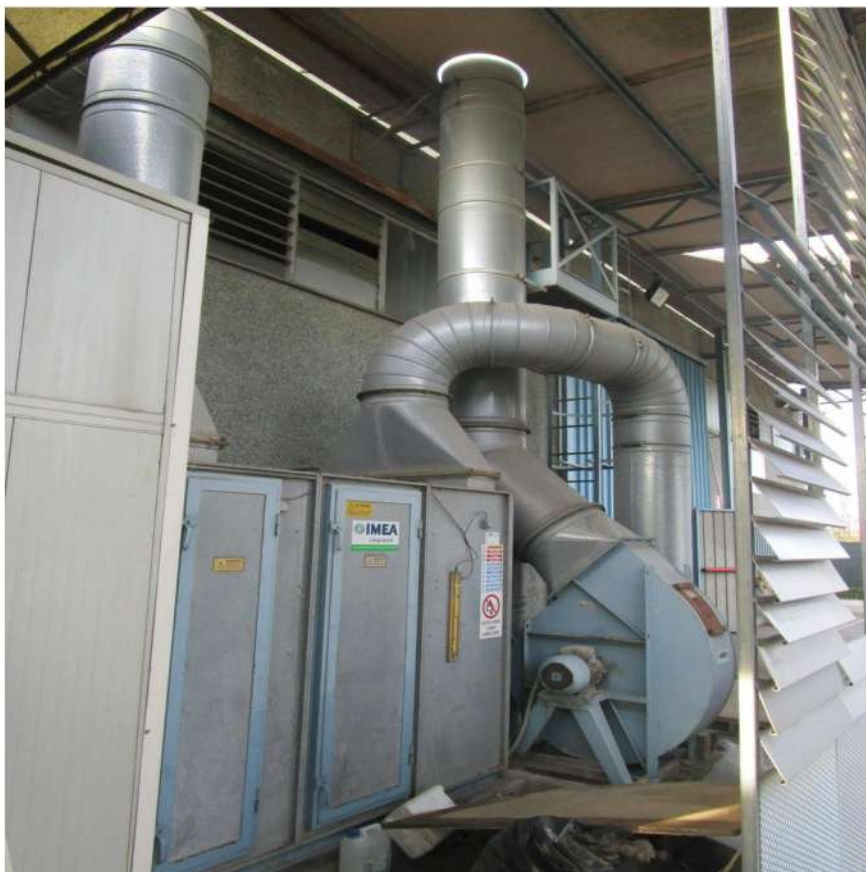
N° 22 – Vista esterna: Impianto di aspirazione polveri e fumi
