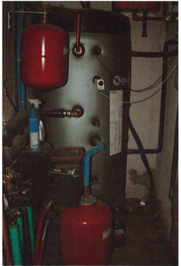
Foto 23. Vano tecnico corpo 2, sub.7
