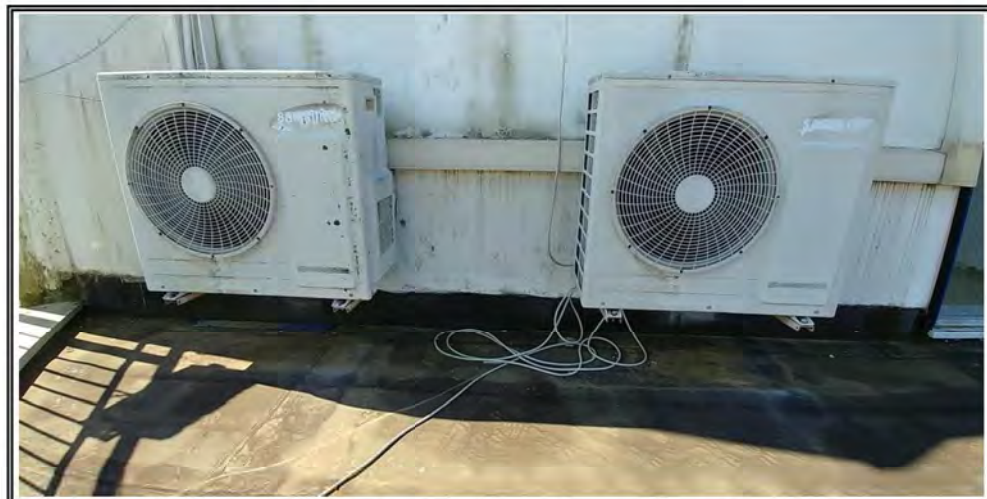
Foto n. 14 – Subalterno 3 – Piano Primo – Impianto condizionamento
