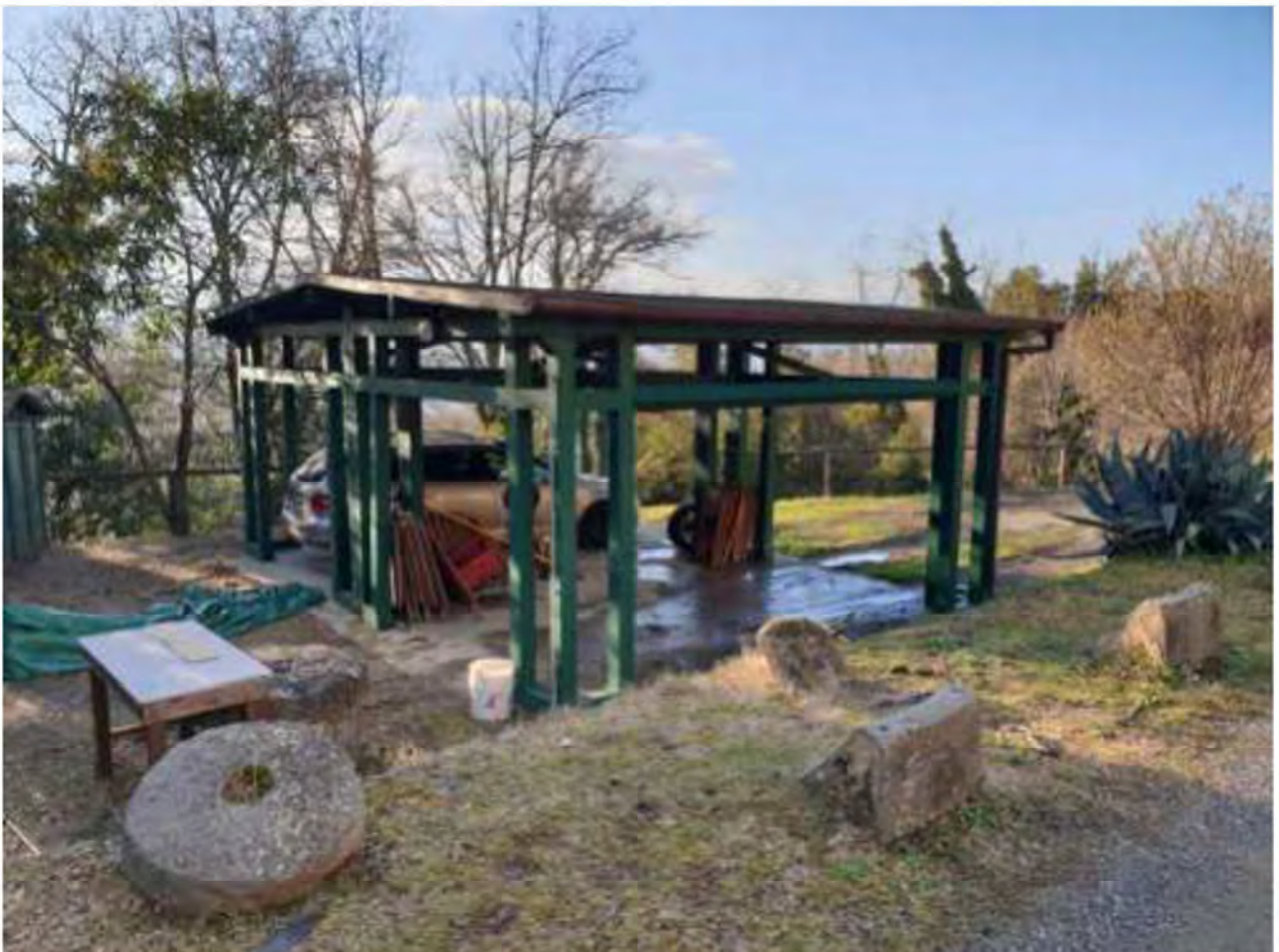
FOTO 142. Tettoia per ricovero veicoli abusiva
