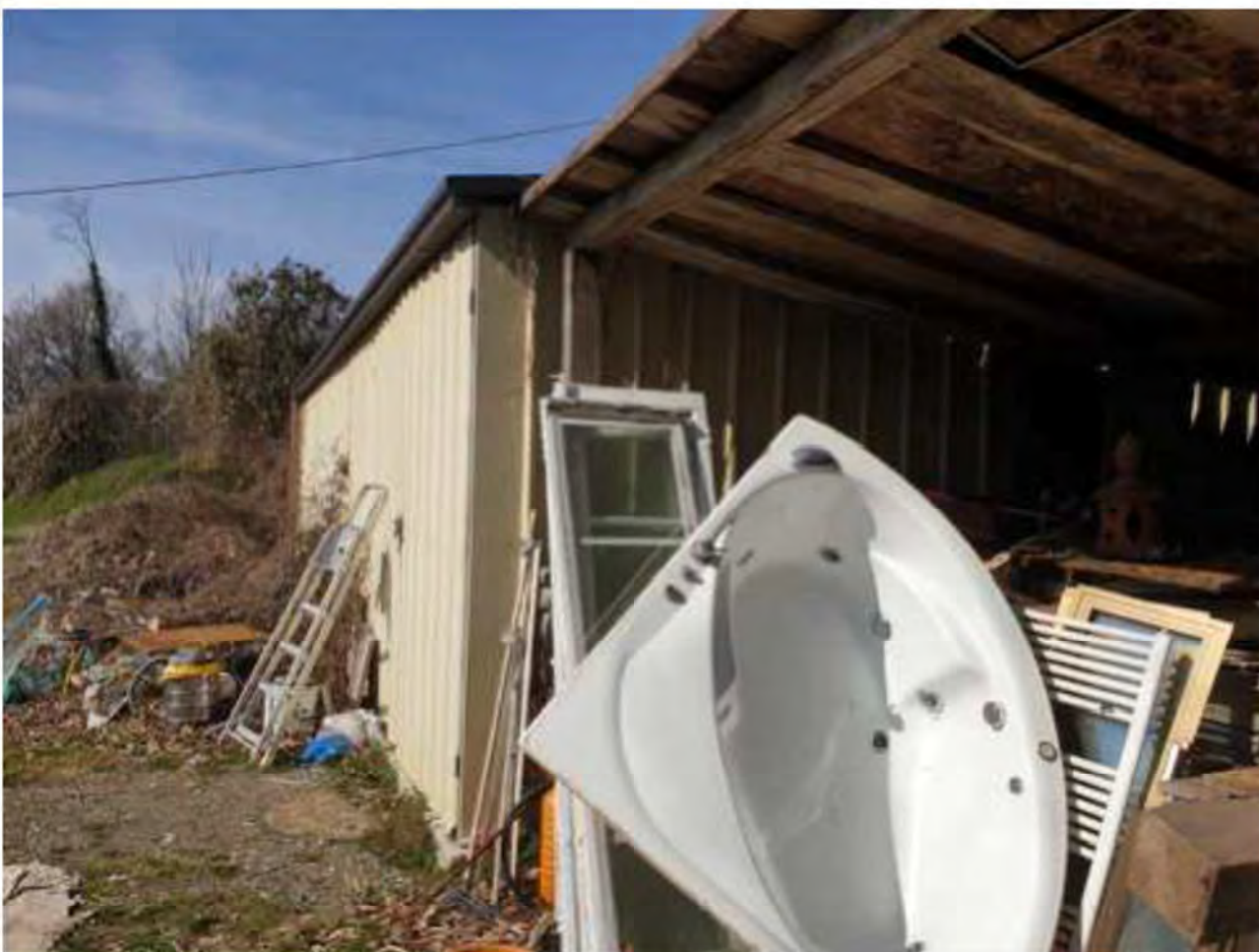
FOTO 211. Baracche da smantellare su mapp. 620
