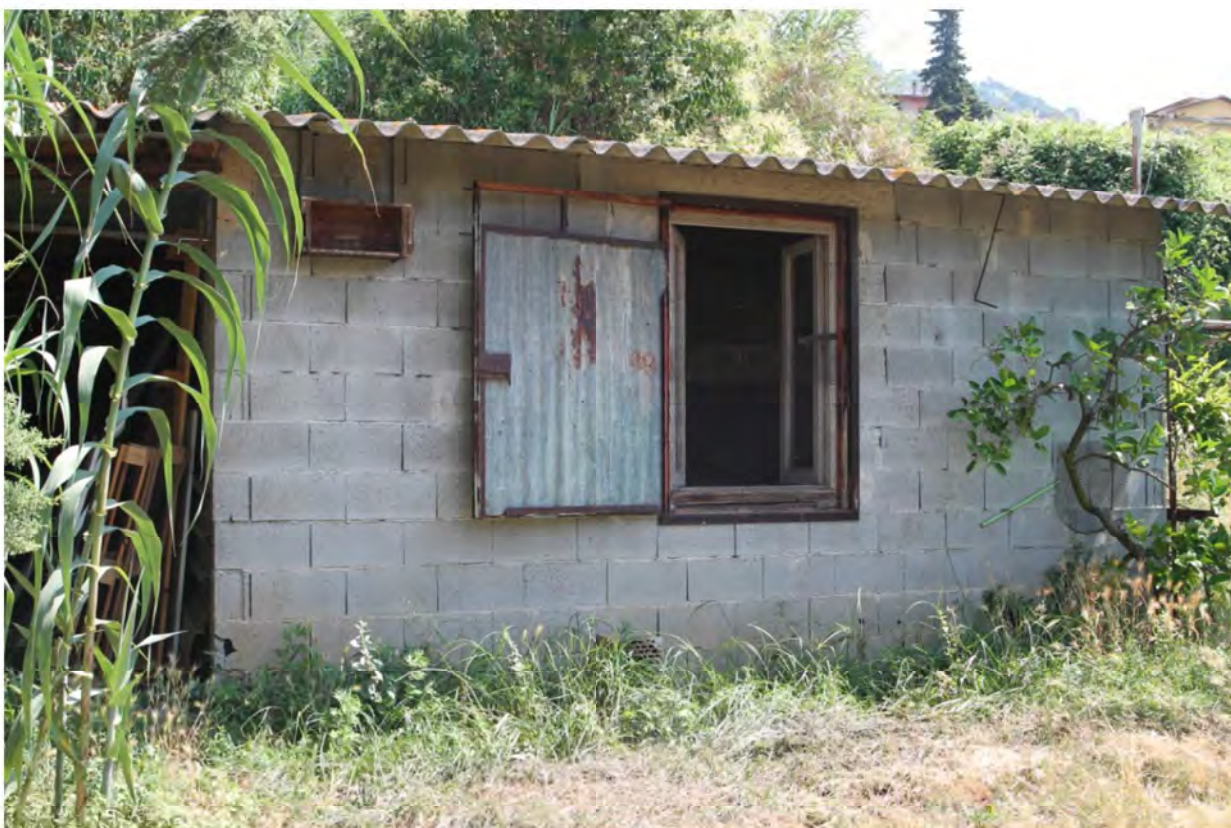
Foto 66. Manufatto abusivo realizzato all'interno del Fg. 63 Mapp. 889
