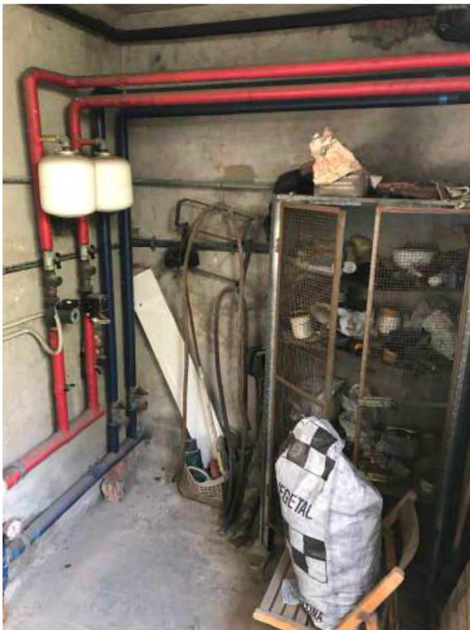
Foto 1: Marina di Massa, Massa. Lotto 001. Centrale Termica.
