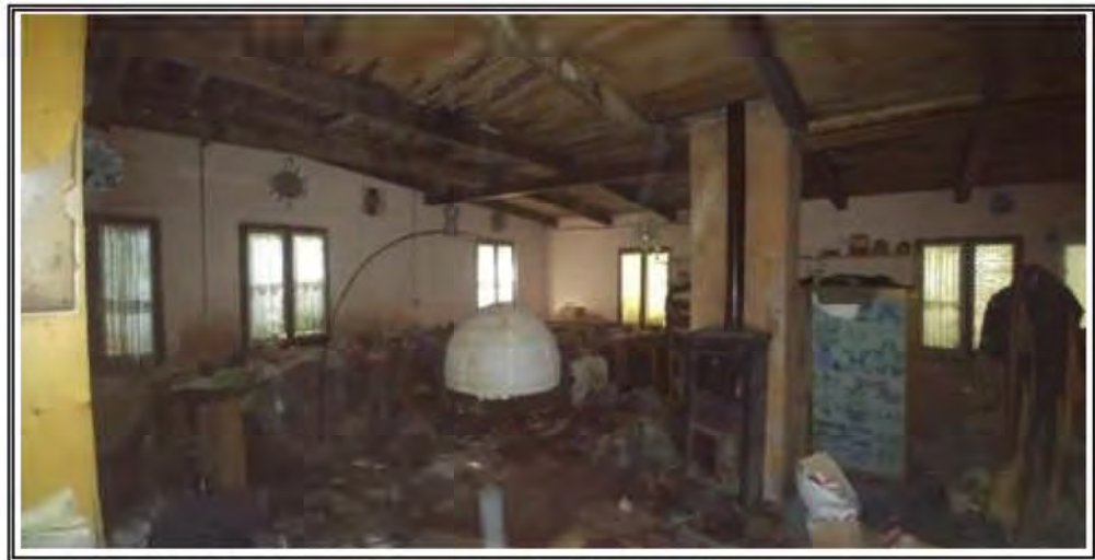
Foto n. 16 – Soggiorno (opera abusiva da demolire)
