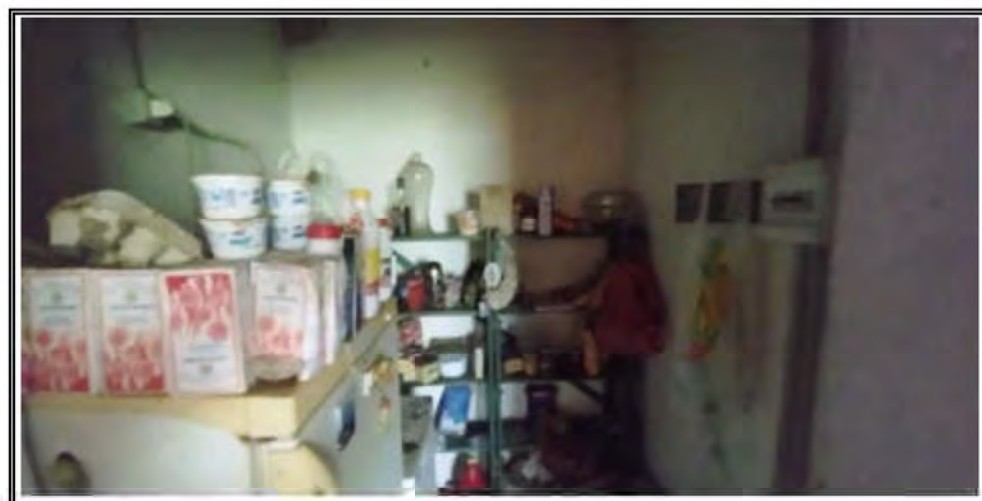
Foto n. 15 – Ripostiglio (Opera abusiva da demolire)
