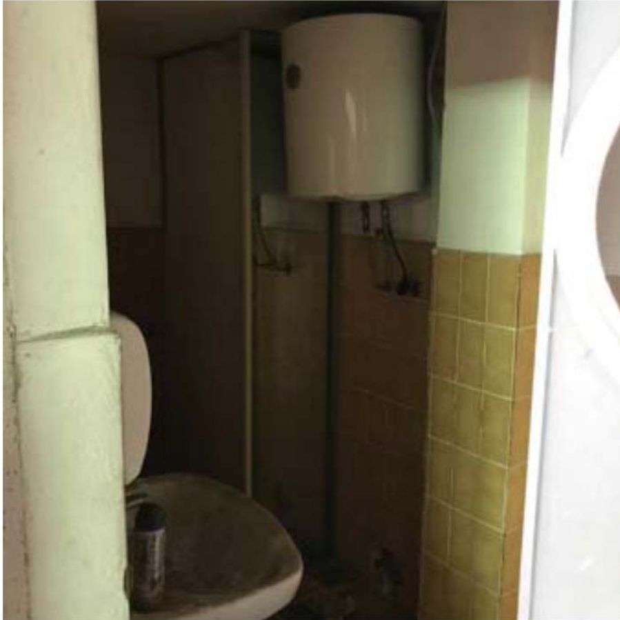
Foto 9: Via Provinciale Avenza-Sarzana. WC.
