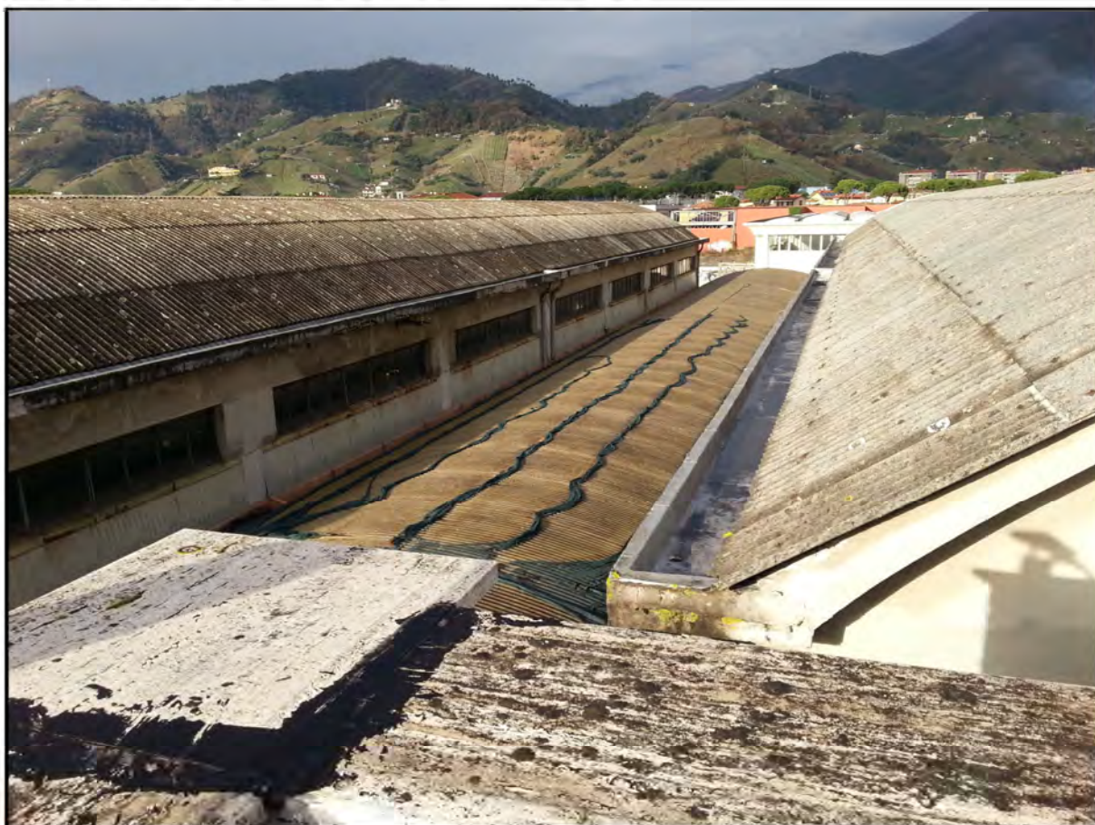
Figura 2. Veduta della copertura del reparto produttivo. Si vedono due delle quattro campate con copertura in fibrocemento e la campata centrale con copertura in onduline plastiche
