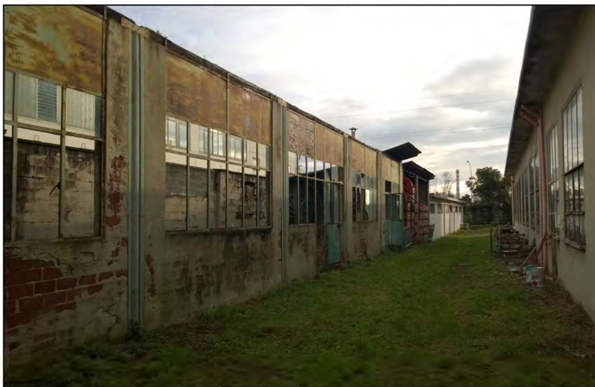
Figura 4. Immagine ripresa sul lato Massa del corpo centrale con direzione mare. A sinistra è evidente lo stato di conservazione di parte del corpo accessorio che in passato è stato interessato da un incendio
