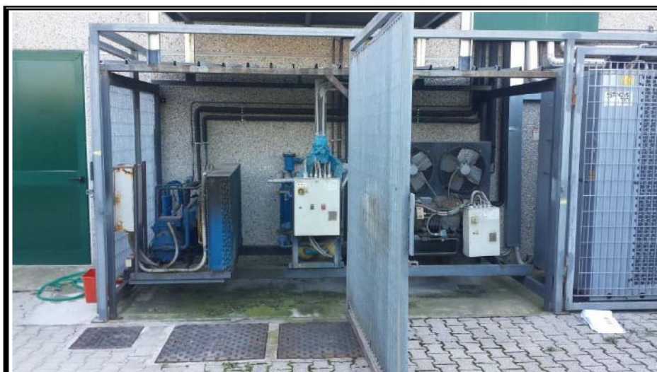
Foto n. 71– Impianto condizionamento e refrigeramento celle frigo
