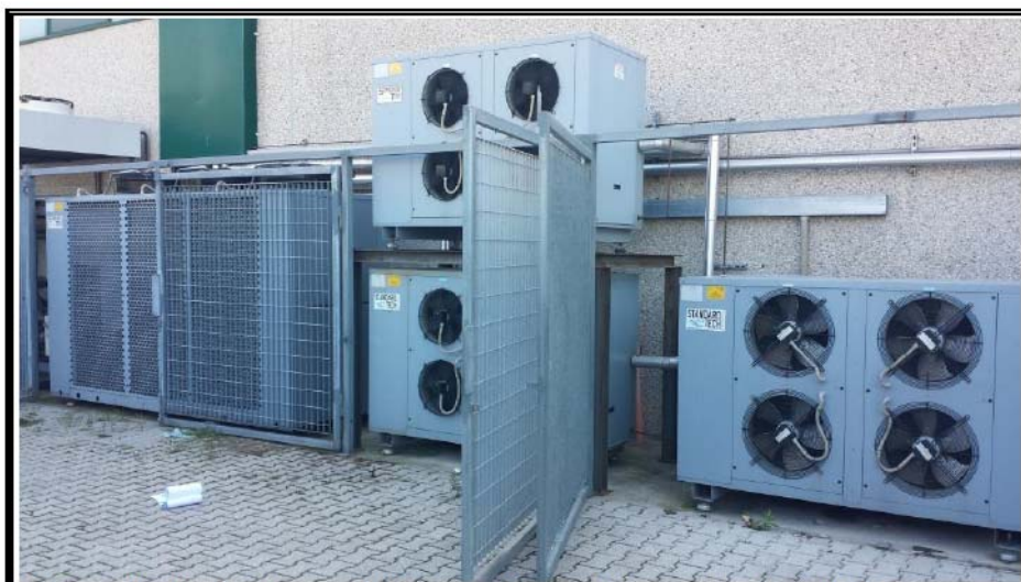
Foto n. 70– Impianto condizionamento e refrigeramento celle frigo
