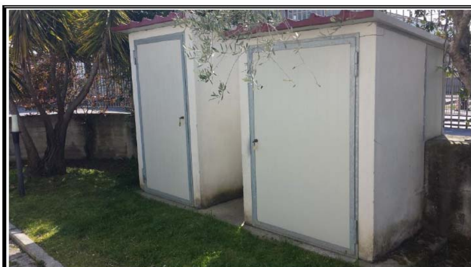
Foto n. 88– casotto impianto elettrico
