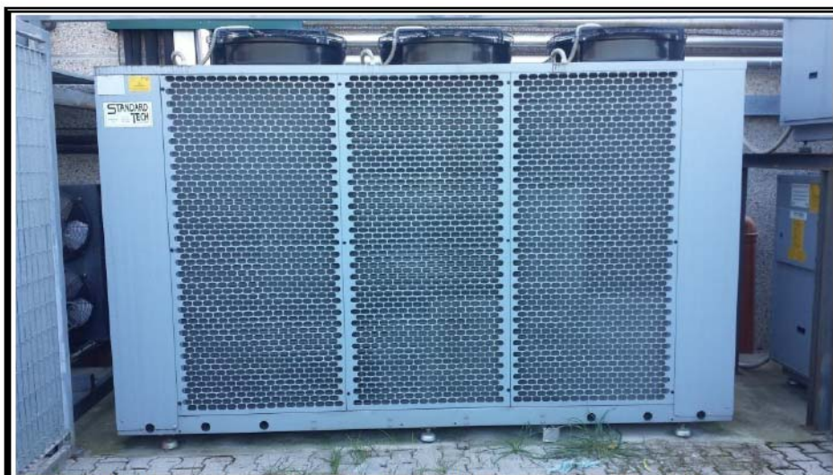
Foto n. 76- Compressore impianto condizionamento laboratorio
