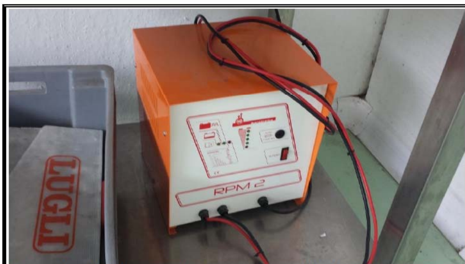
Foto n. 42 – Art. 36 – caricabatteria per transpallet elettronico
