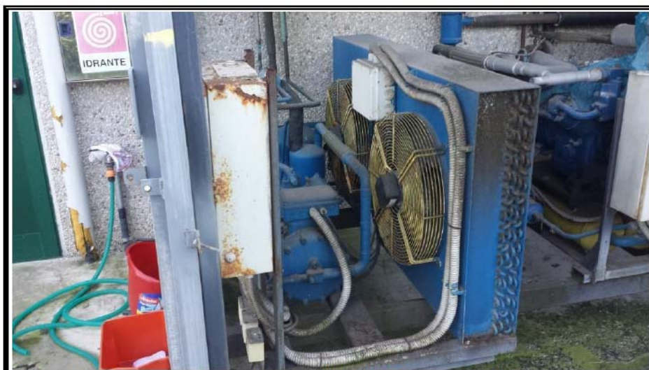
Foto n. 81- Compressore collegato all'abbattitore vano 30
