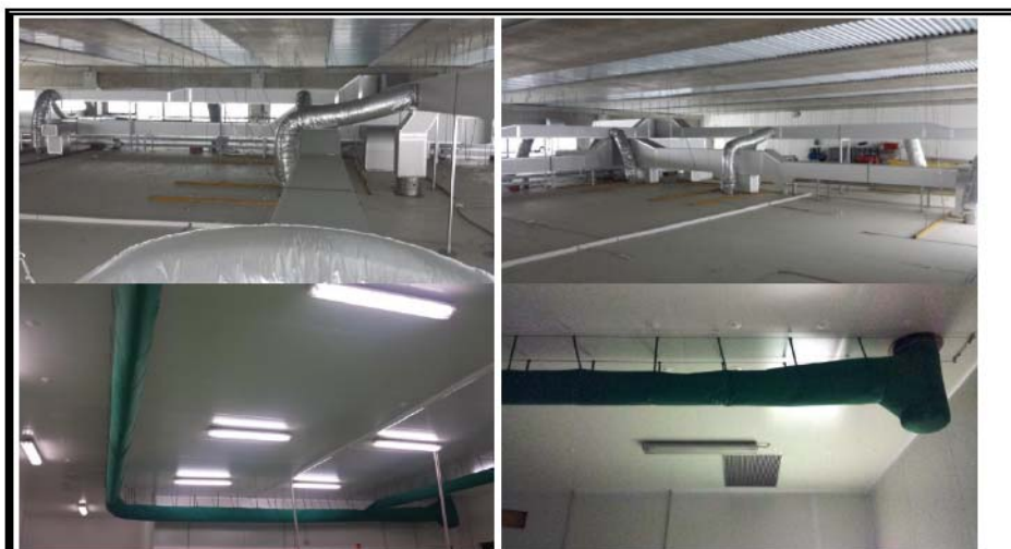
Foto n. 78 - Canalizzazioni piano mezzanino e diffusori laboratorio
