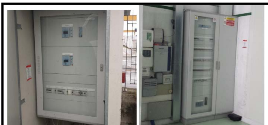
Foto n. 89 – Impianto elettrico – quadro esterno e vano 35
