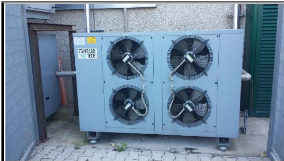
Foto n. 72 – Compressore celle 2, 3 e 4
