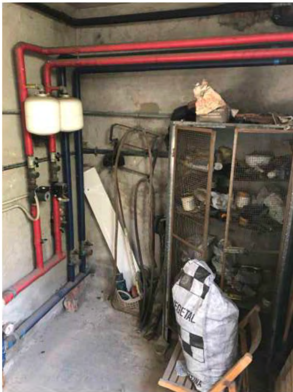
Foto 1: Marina di Massa, Massa. Lotto 001. Centrale Termica.
