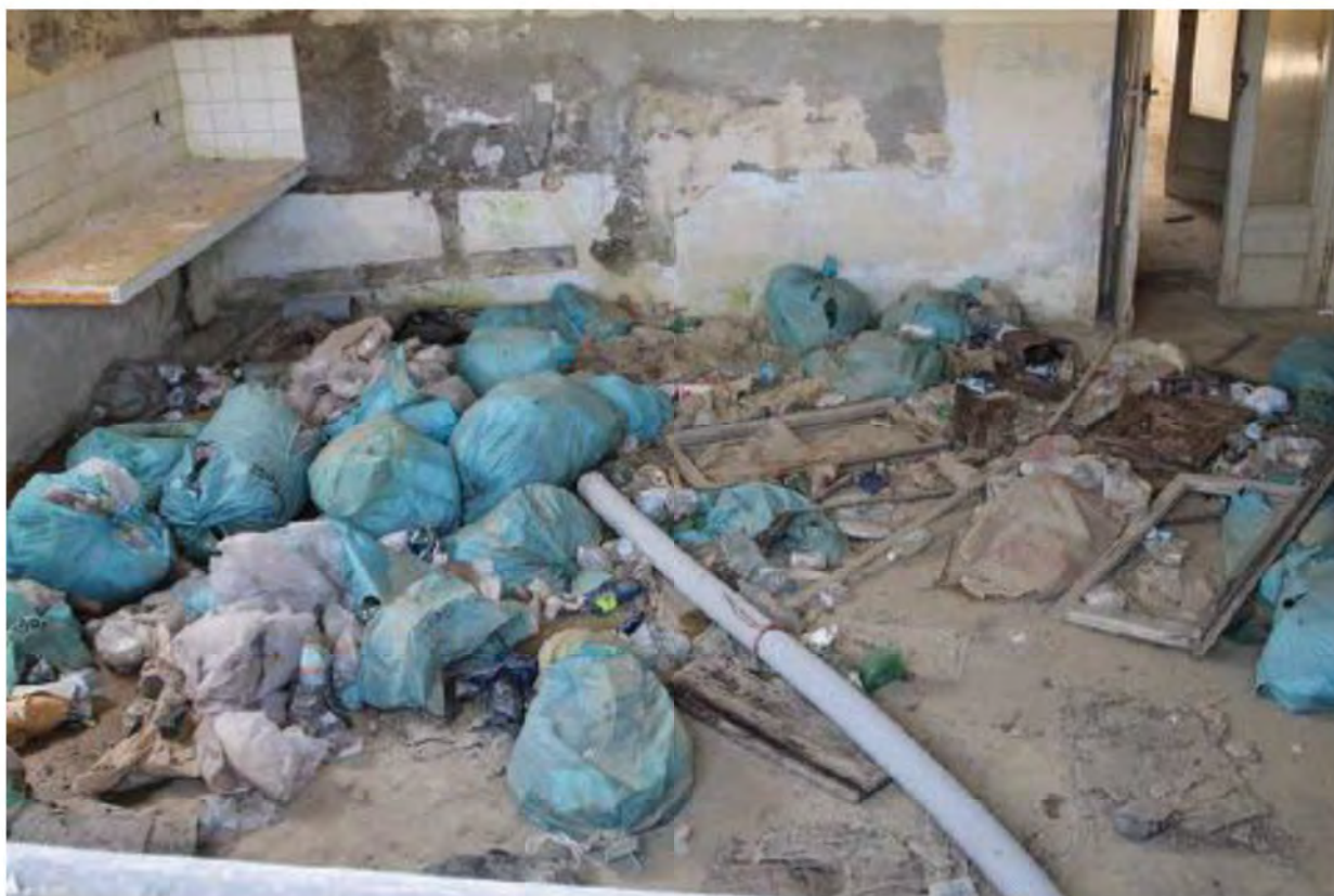
Foto 18. Interno edificio n°20, rifiuti nel seminterrato
