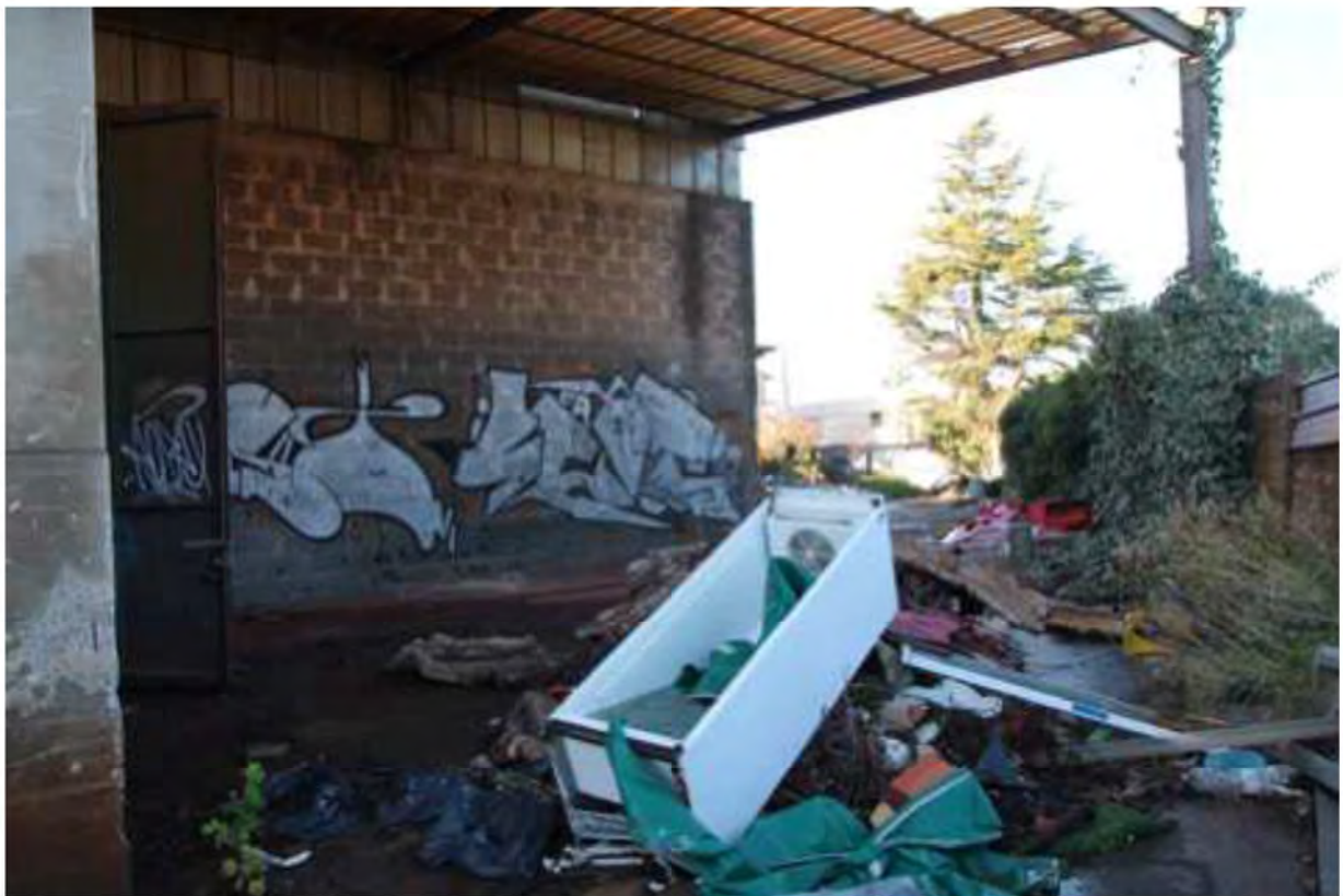
FOTO 4. Tettoia abusiva lato monti del capannone principale mapp.50
