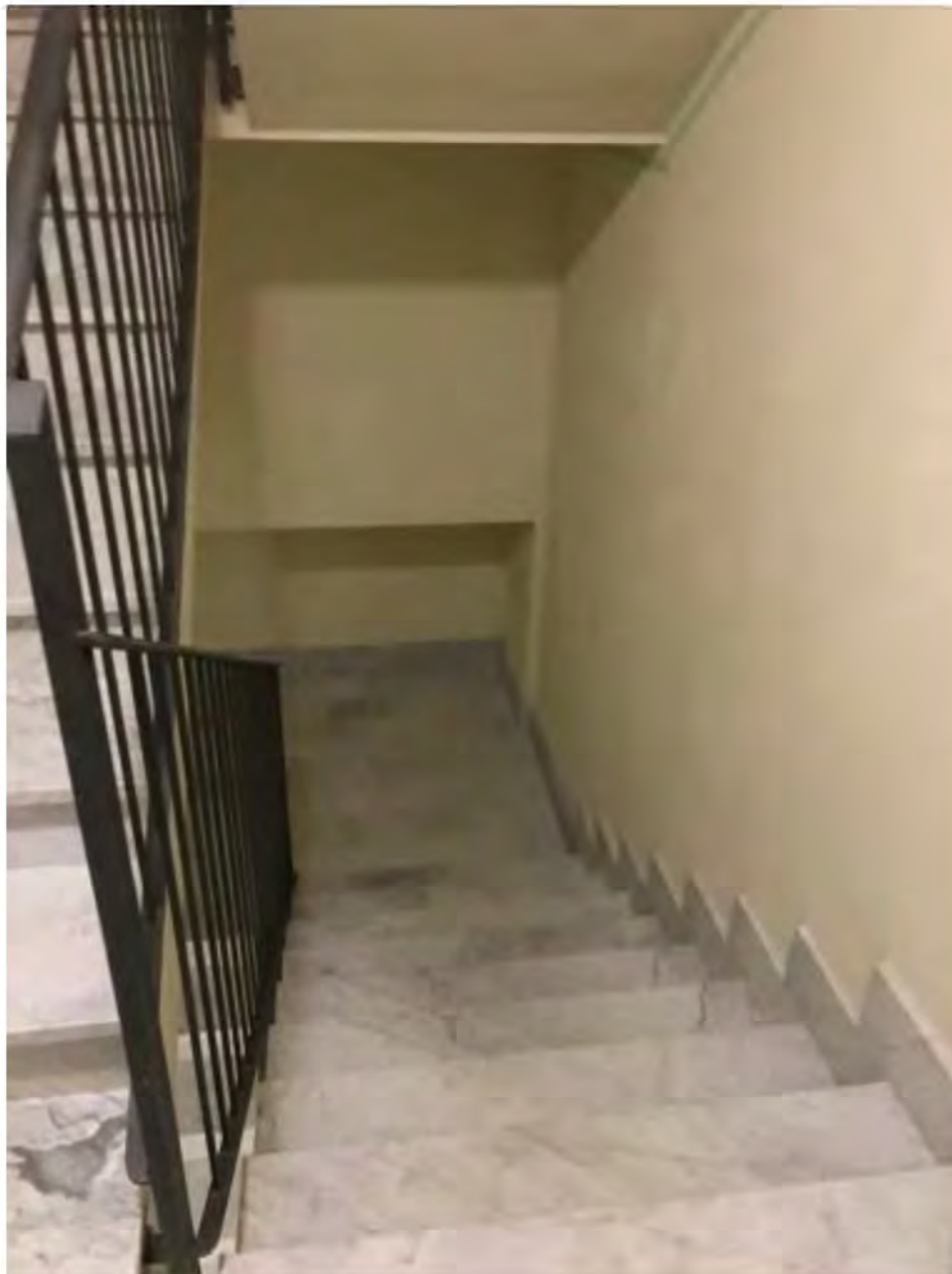
Foto E6: Largo Altiero Spinelli, Licciana Nardi, Località Masero, Terra Rossa Lotto 004 . Vano scala
