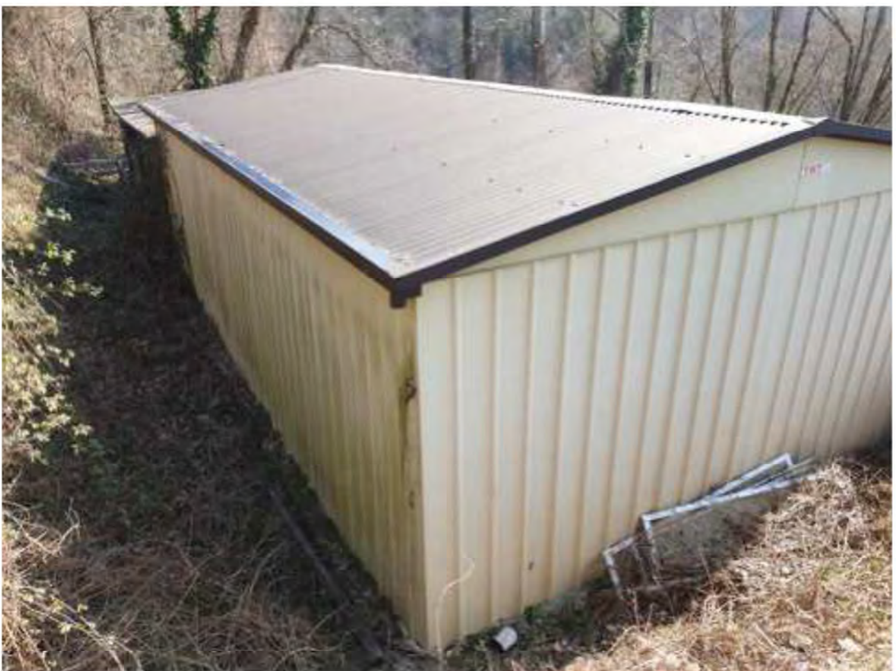
FOTO 209. Baracche da smantellare su mapp. 620
