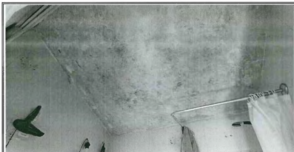
Foto n. 12 – Particolare soffitto del bagno
