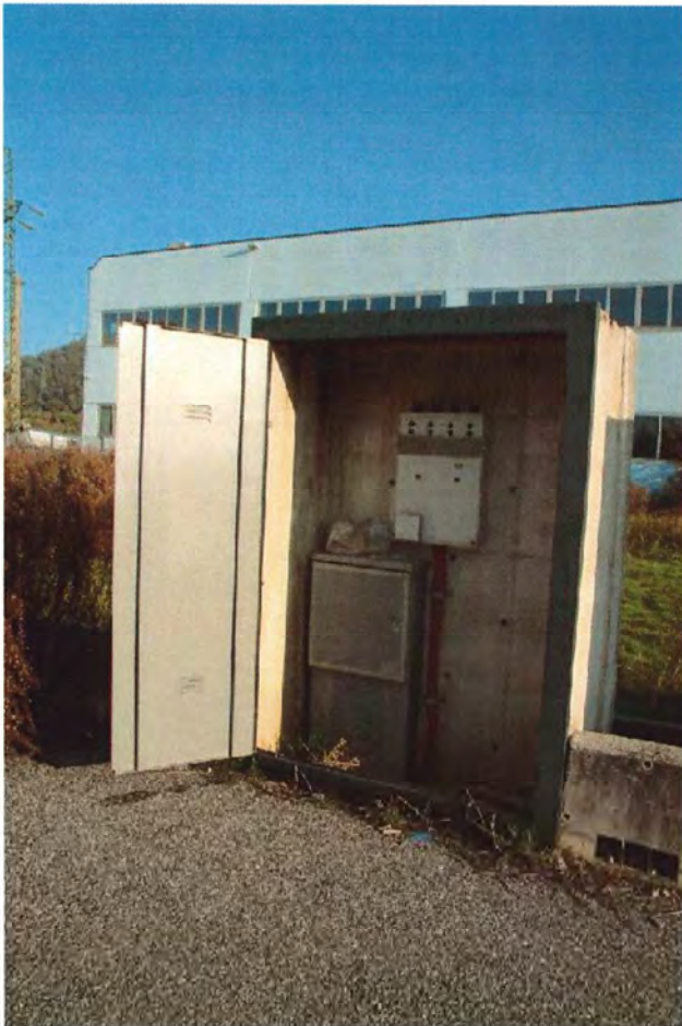
Foto 35. Cabine esterne per impianti
