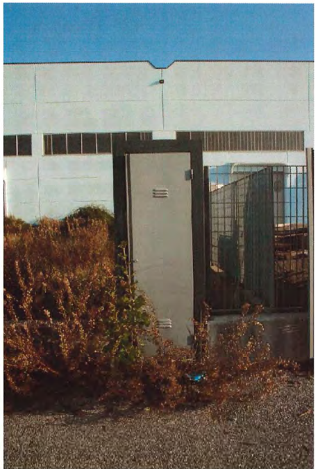
Foto 36. Cabine esterne per impianti
